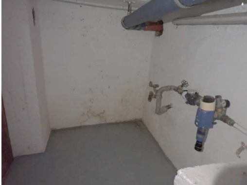
Kellerraum mit Übernahmestation Wasser
