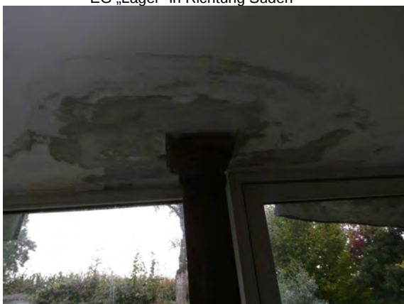
... jeweils mit deutlich erkennbaren Wasserschäden wegen undichter Terrasse darüber
