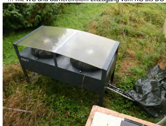
KNV Wärmepumpe östlich des „Liftturmes“
