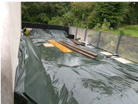
OG westseitige dzt. undichte Terrasse
