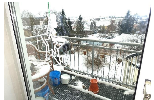
Balkon: vorgesetzter Balkon; Metallständerkonstruktion mit Geländer, Gitterroste und einer Wendeltreppe jeweils verzinkt;
