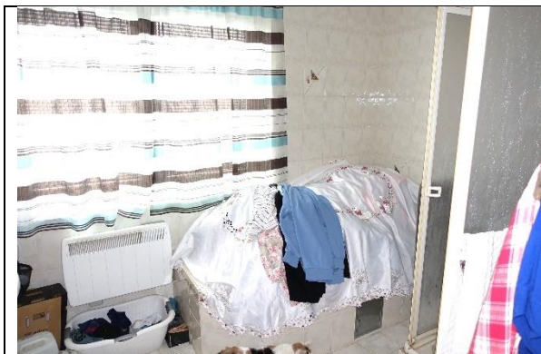
Sanitärausstattung: 1 Eckdusche mit Duschtrennwand, 2 Waschbecken jeweils mit Seiten- und Unterschrank; 1 Badewanne, 1 Waschmaschinenanschluss; 1 Elektroheizlüfter;
