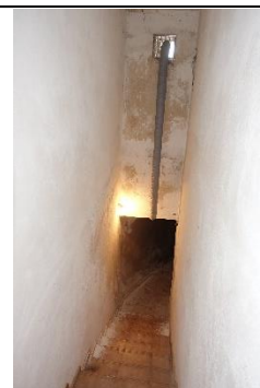
Treppe Hobbyraum/unterirdischer Gang: Massivtreppe mit Fliesenbelag; erkennbare Feuchtigkeitsschäden an Wand und Decke;
