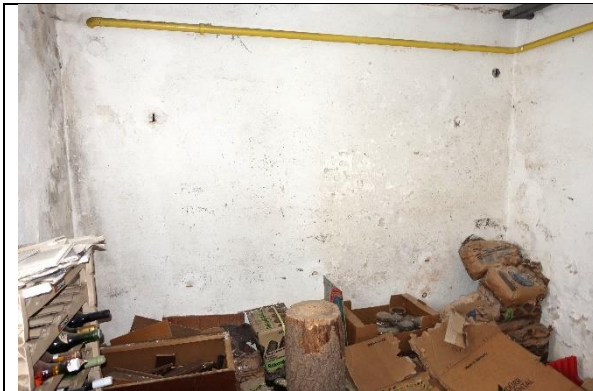
Lagerkeller: Boden: Fliesen; Wände und Decke: verputzt und gemalt; erkennbare Feuchtigkeitsschäden im Bereich Boden/Wand
