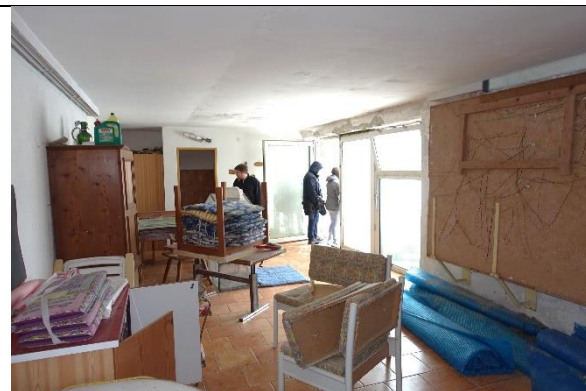
Hobbyraum: Boden: Fliesen; Wände: verputzt und gemalt; Decke: Stahlbetondecke versiegelt; erkennbare Feuchtigkeitsschäden an den Wänden und der Decke;
