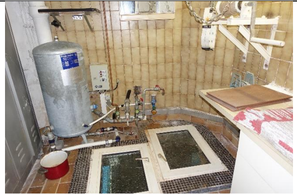
Brunnenraum: Boden: Fliesen mit 2 eingebauten Kunststoffflügeln mit Verglasung in den darunter liegenden Schachtbrunnen; Wände: Fliesen; Decke: Stahlbetondecke geweißt; 1 Hauswasserwerk mit Druckkessel;
