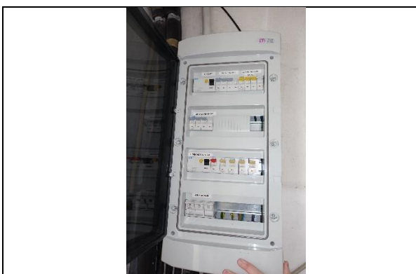
Elektroverteilerschrank neu für Pool und Garage
