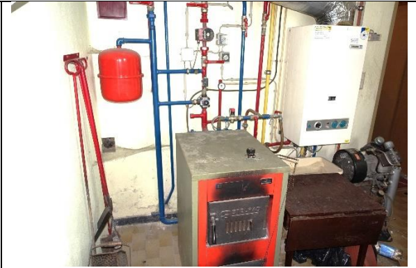
Heizraum: Boden: Fliesen; Wände und Decke: verputzt und gemalt; 1 Festbrennstoff-Heizkessel, 1 Erdgastherme kamingegebunden;
