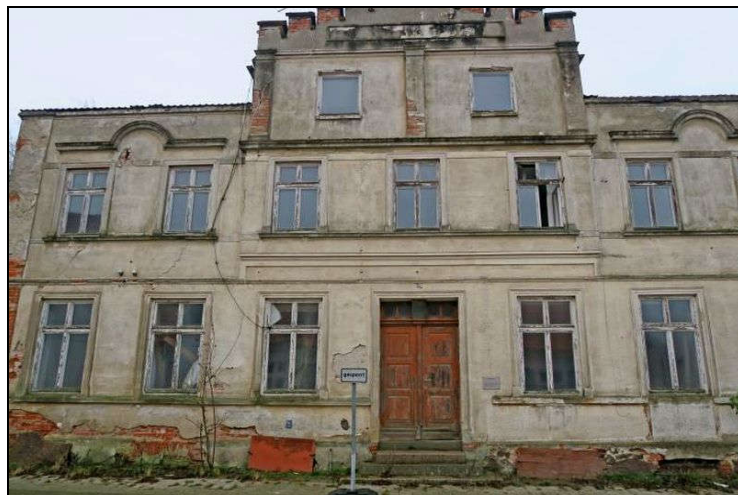
Blick auf das ruinöse Mehrfamilienhaus aus Richtung der August-Bebel-Straße
