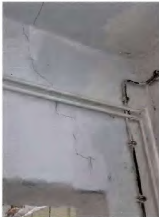
Bild 14 - Detail Riss Innenwand
