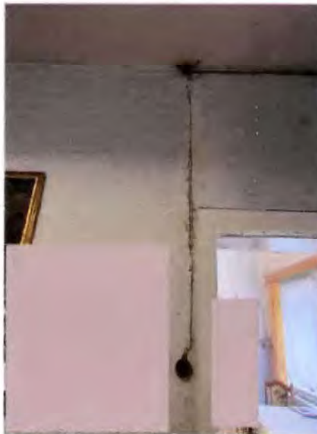
Bild 18 - Detail Elektro Raum 7
