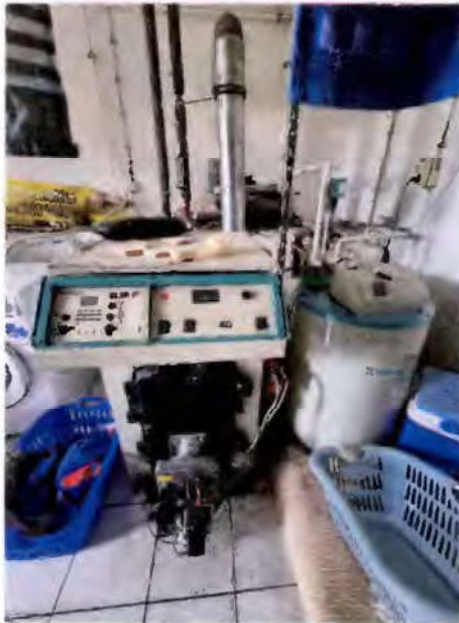
Bild 15 - Detail Heizung in Raum 4
