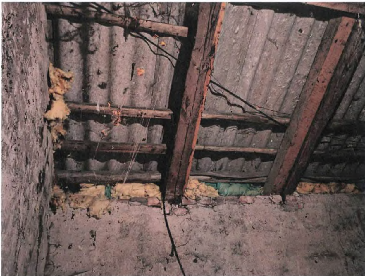
W-25-035 Bild 45 - Wellasbest unter der Blechdachdeckung
