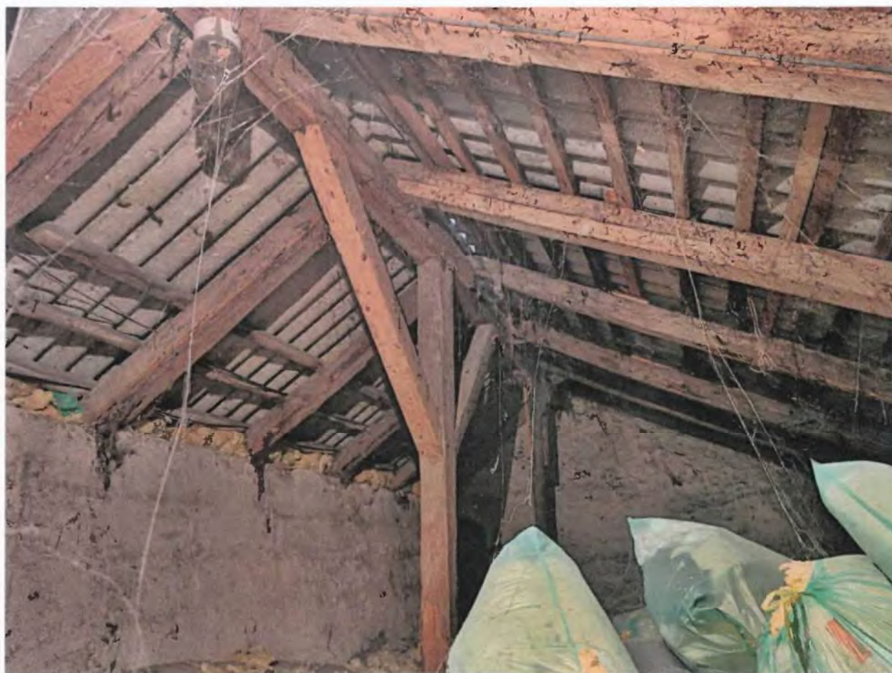
W-25-035 Bild 46 - Wellasbest unter der Blechdachdeckung
