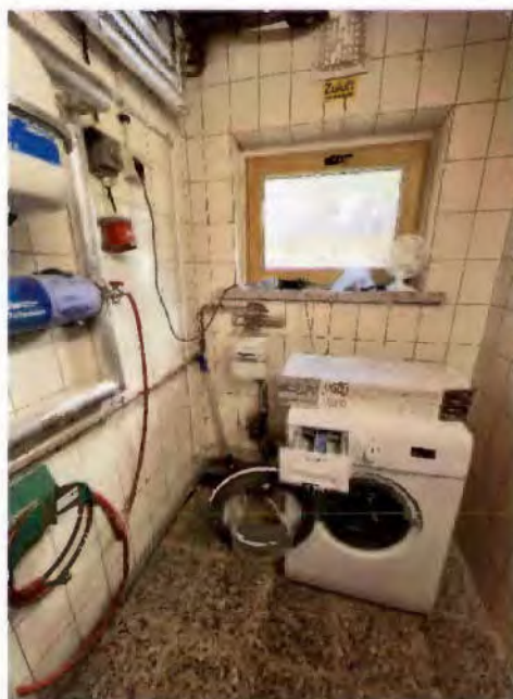
Bild 36 - Blick in den Heizungsraum
