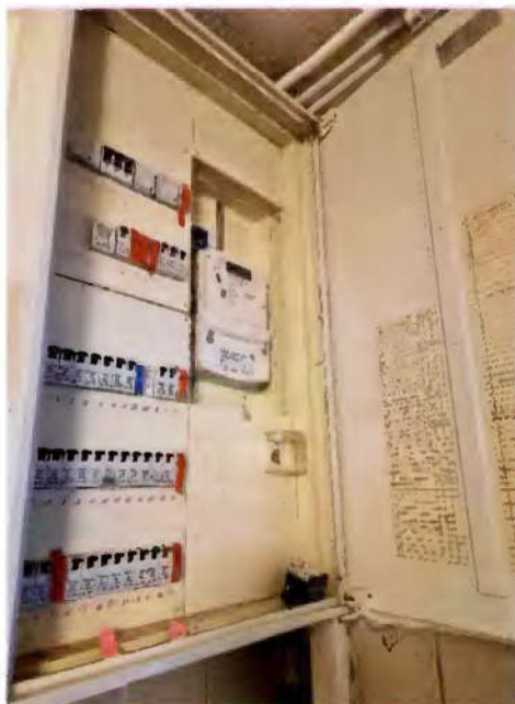
Bild 34 - E-Verteilerkasten im gartenseitigen Kellerflur
