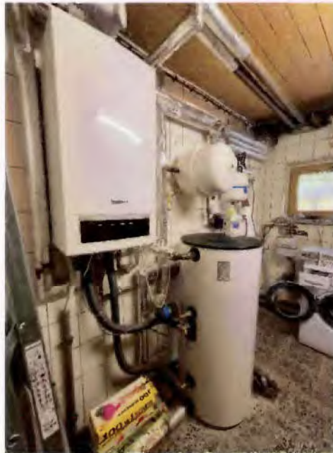
Bild 35 - Haustechnik im Heizungskeller
