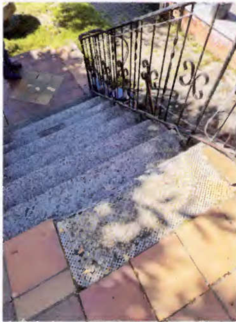
Bild 7 - Detail der sanierungsbedürftigen Hauseingangstreppe
