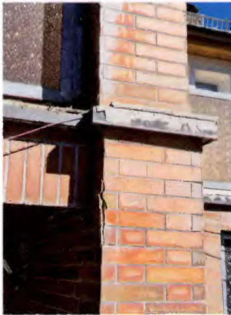
Bild 9 - schadhafter Gebäudesockel (Bereich des Eingangspfeilers zur Garage)
