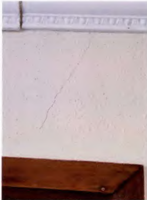
Bild 23 - Risserscheinung oberhalb der Tür im Esszimmer
