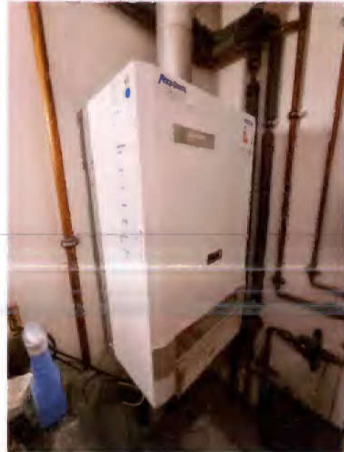
Heizungsanlage im Dachgeschoss
