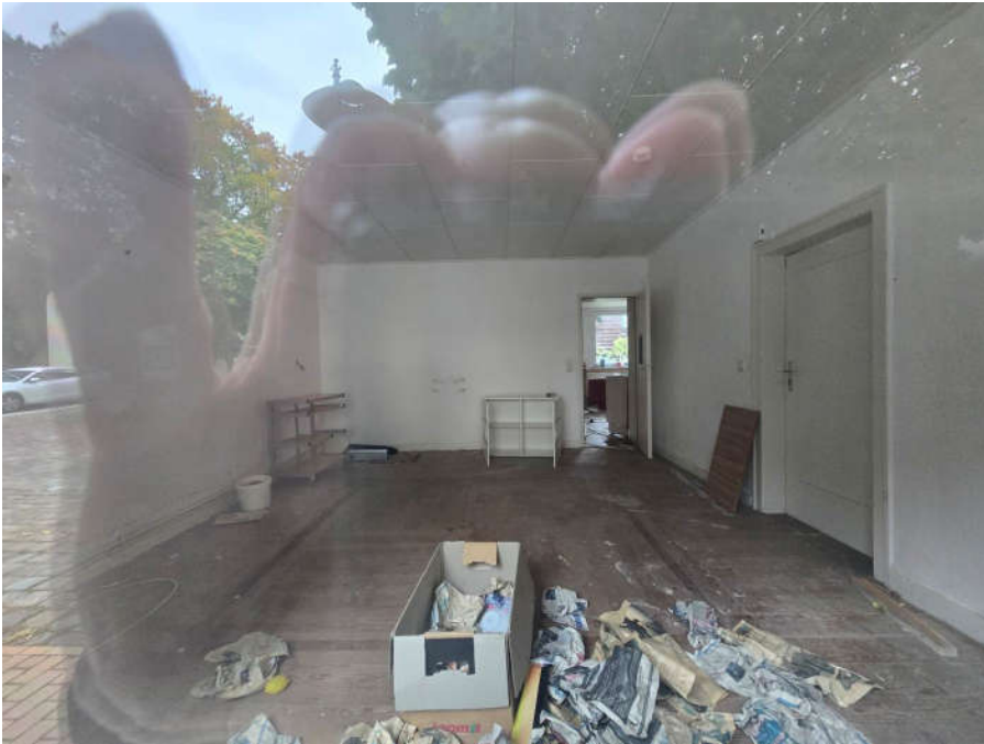
↑ Bild 7: Blick durch ein Fenster in die ehemalige Erdgeschosswohnung
