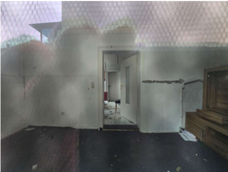
↑ Bild 6: Blick durch ein Fenster in die ehemalige Erdgeschosswohnung
