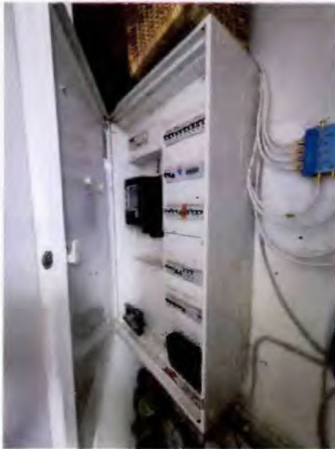
29 ehem. Ferienwohnung E-Technik im Heizungsraum
