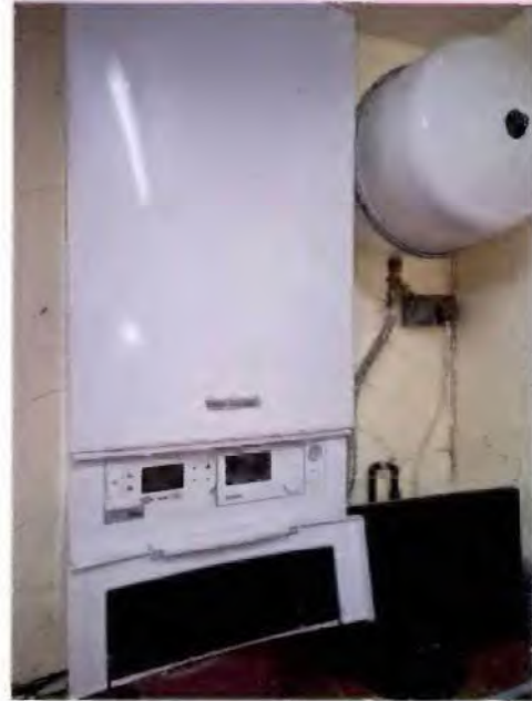
34 ehem. Ferienwohnung Heizung
