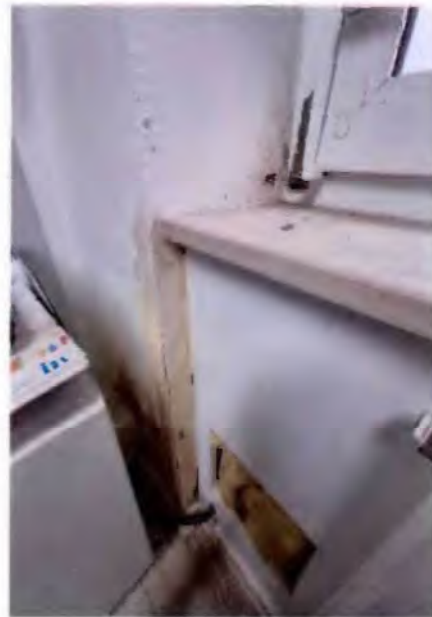
30 ehem. Ferienwohnung Büro Feuchtigkeitsschaden
