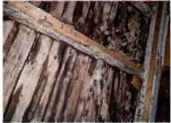
18 DG Feuchtigkeitsschäden (Haupthaus)
