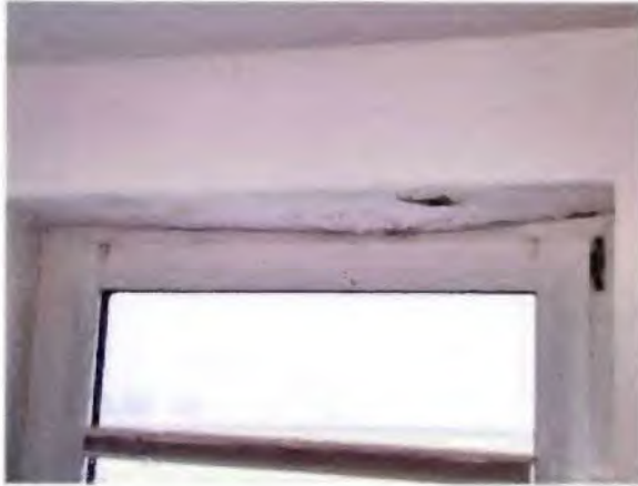
33 ehem. Ferienwohnung Feuchtigkeitsschaden Fenstersturz
