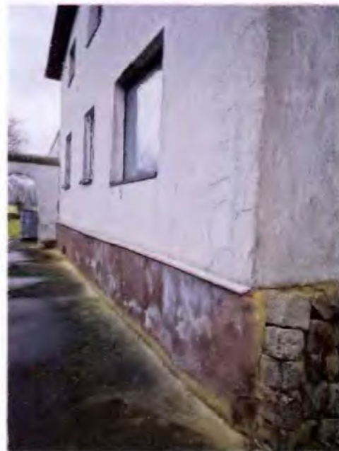
08 Schäden am Putz (am Haupthaus)
