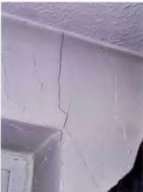
31 ehem. Ferienwohnung Bad Rissbildung
