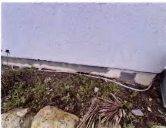
39 Nebengebäude Poolhaus Schäden am Sockel
