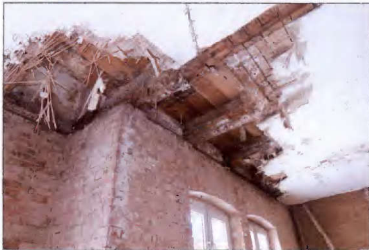
massive Schäden an den Deckenbalken (West-Seite Erdgeschoss)
