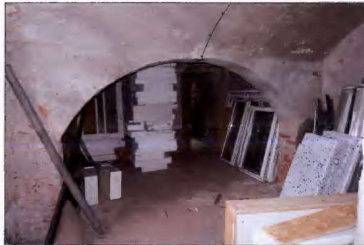
Kellerraum mit alten Baustoffen (Beräumungsbedarf)
