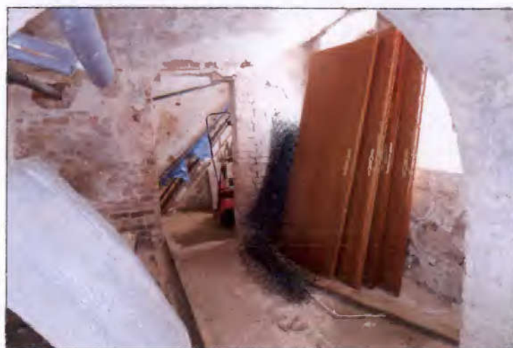
Kellerraum mit alten Baustoffen (Beräumungsbedarf)
