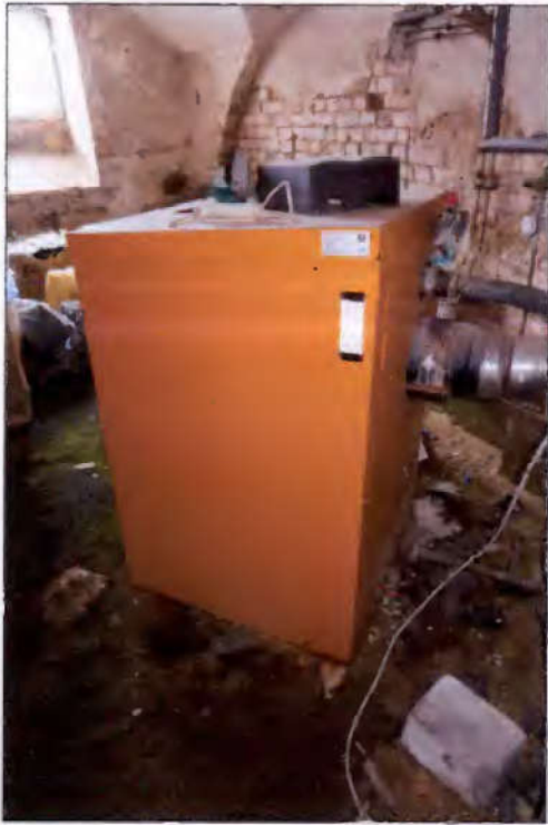
ehemalige Ölheizung (Beräumungsbedarf)
