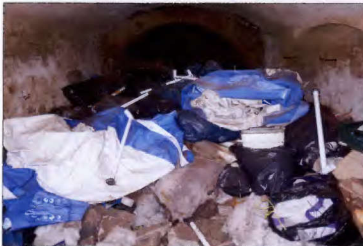
Blick in einen Kellerraum mit Beräumungsbedarf
