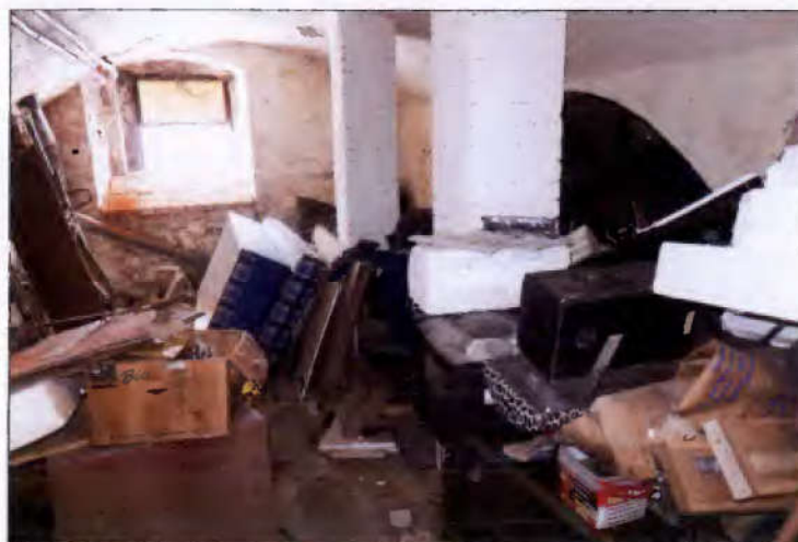
Blick in einen Kellerraum mit Beräumungsbedarf
