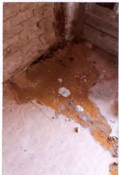
Detailansicht des Myzels (Verdacht auf Echten Hausschwamm)
