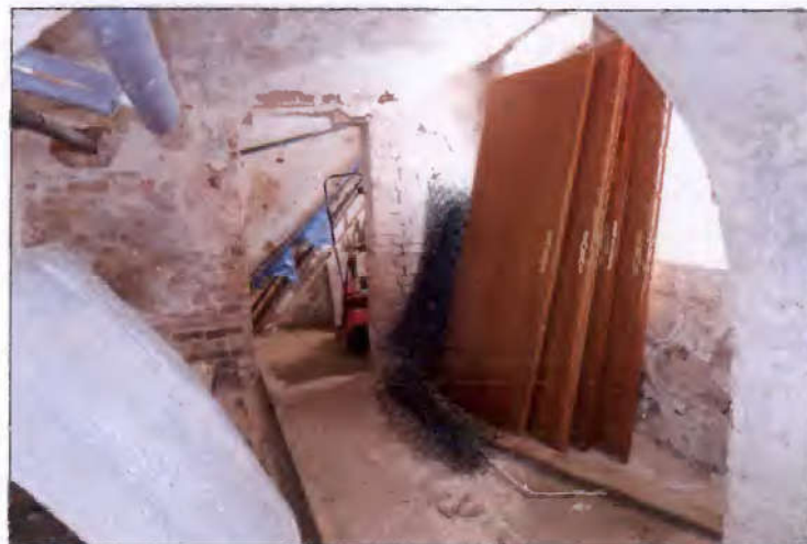
Kellerraum mit alten Baustoffen (Beräumungsbedarf)
