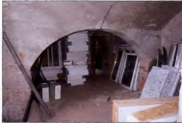
Kellerraum mit alten Baustoffen (Beräumungsbedarf)
