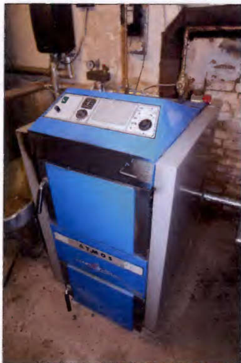
Feststoffbrennkessel für die Beheizung der noch vermieteten Wohnung
