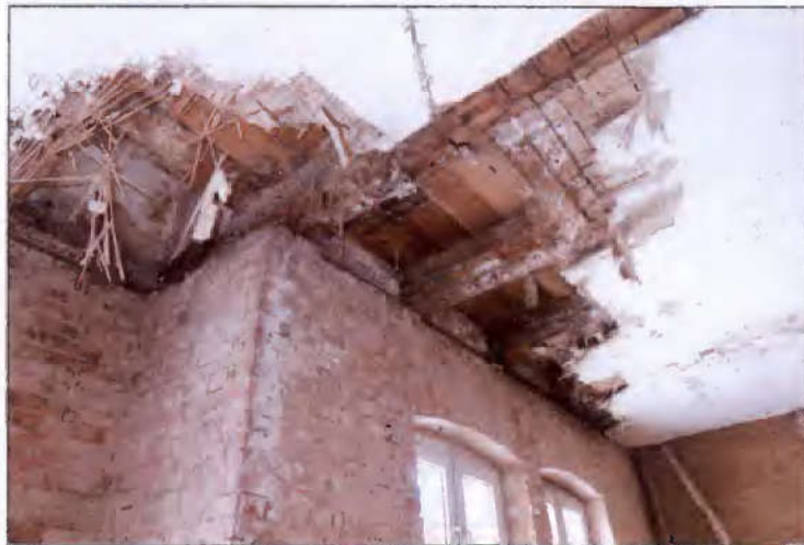
massive Schäden an den Deckenbalken (West-Seite Erdgeschoss)
