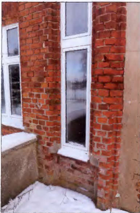
Detailansicht eines Kunststofffensters (nicht denkmalgerecht)
