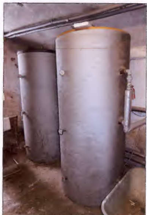
Pufferspeicher für den Feststoffbrennkessel
