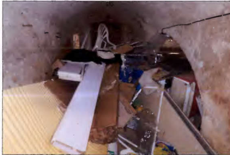
Blick in einen Kellerraum mit Beräumungsbedarf
