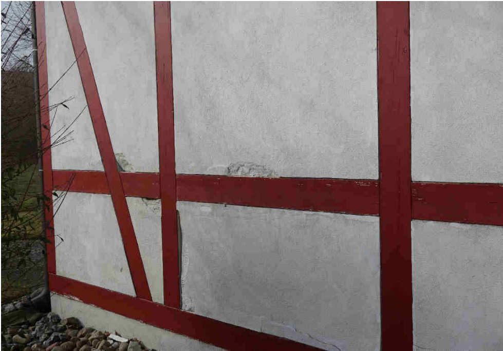
↑ Bild 7: leichte Putzschäden an der Fassade
