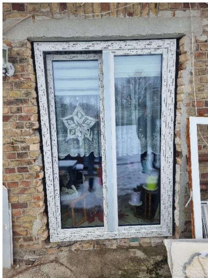
Bild 8: Detail unvollständiger Terrassentüreneinbau
