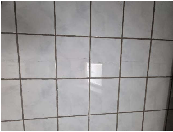
Bild 19: Risse in Badfliesen Whg. 2 DG
