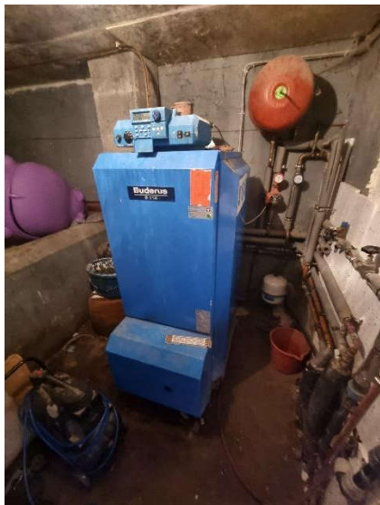
Bild 21: defekter Heizkessel im Nebengebäude
