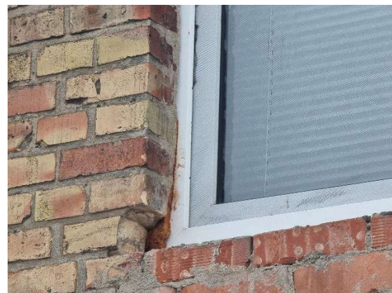
Bild 6: Detail unvollständiger Fenstereinbau
