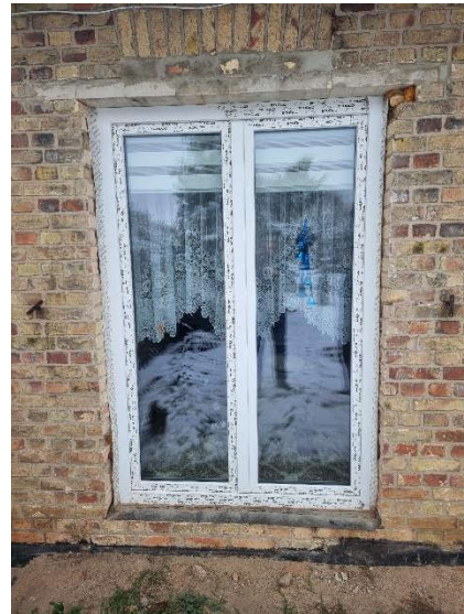
Bild 10: Detail unvollständiger Terrassentüreneinbau
