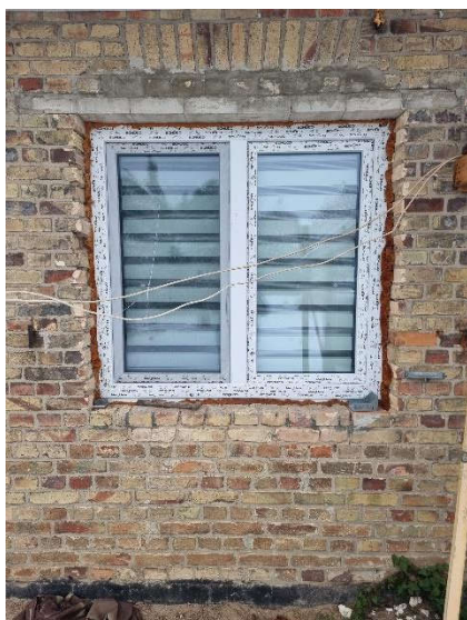
Bild 9: Detail unvollständiger Fenstereinbau
