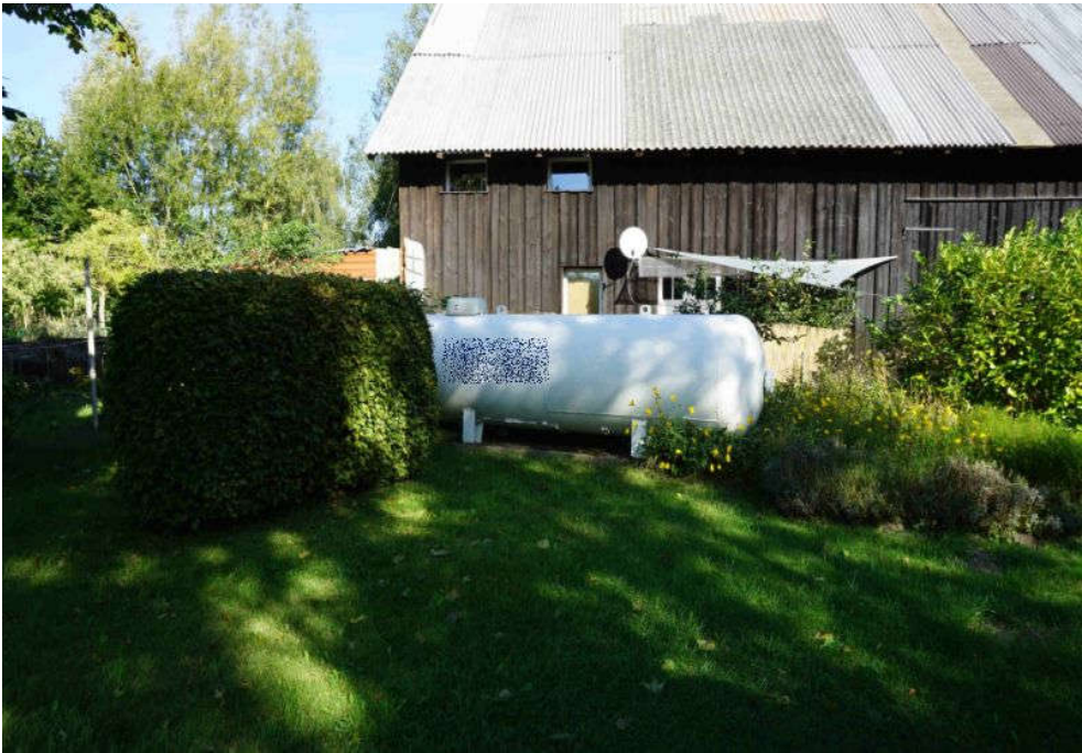
↑ Bild 17: Gastank (Mietbehälter)
