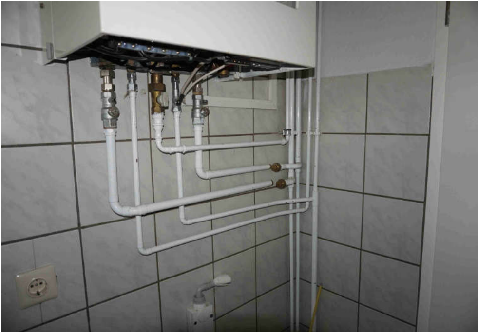
↑ Bild 14: abgeklemmte Gastherme im linken Teil
