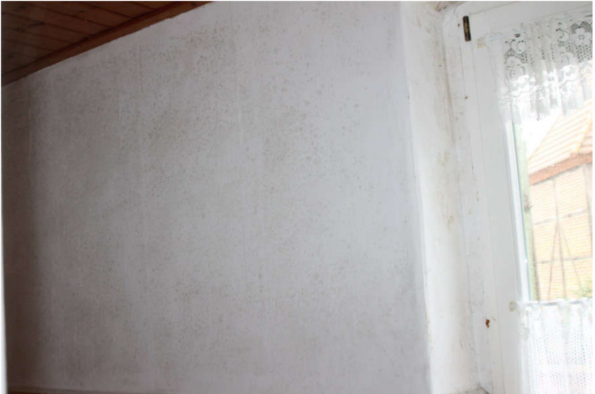
Bild 41: Feuchtigkeitsprobleme (Schimmelpilzbildungen) an den Wandflächen
