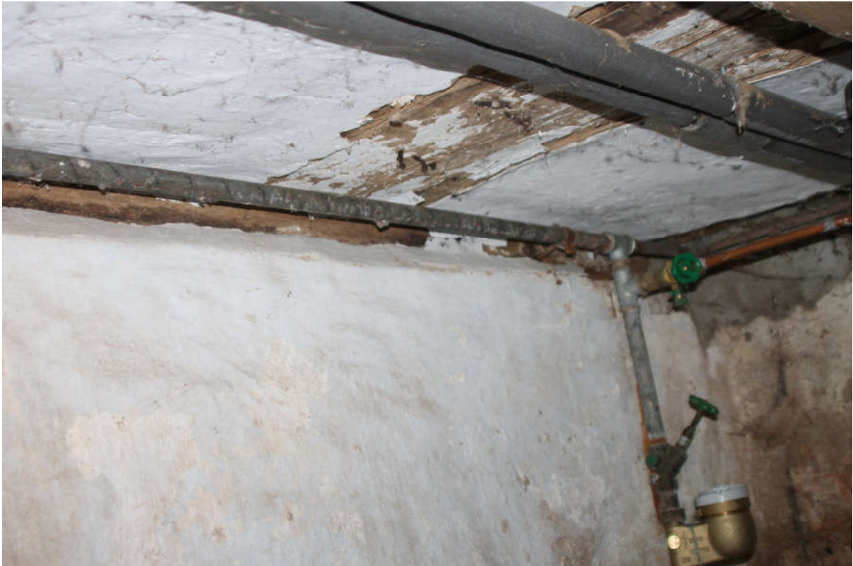
Bild 53: Sicht auf die Installationsleitungen im Keller
