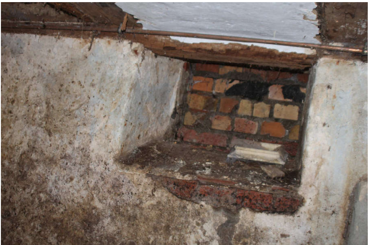
Bild 54: Zustand des Kellers, Holzbalkendecke teilweise mit Braunfäule und Schwamm befallen
