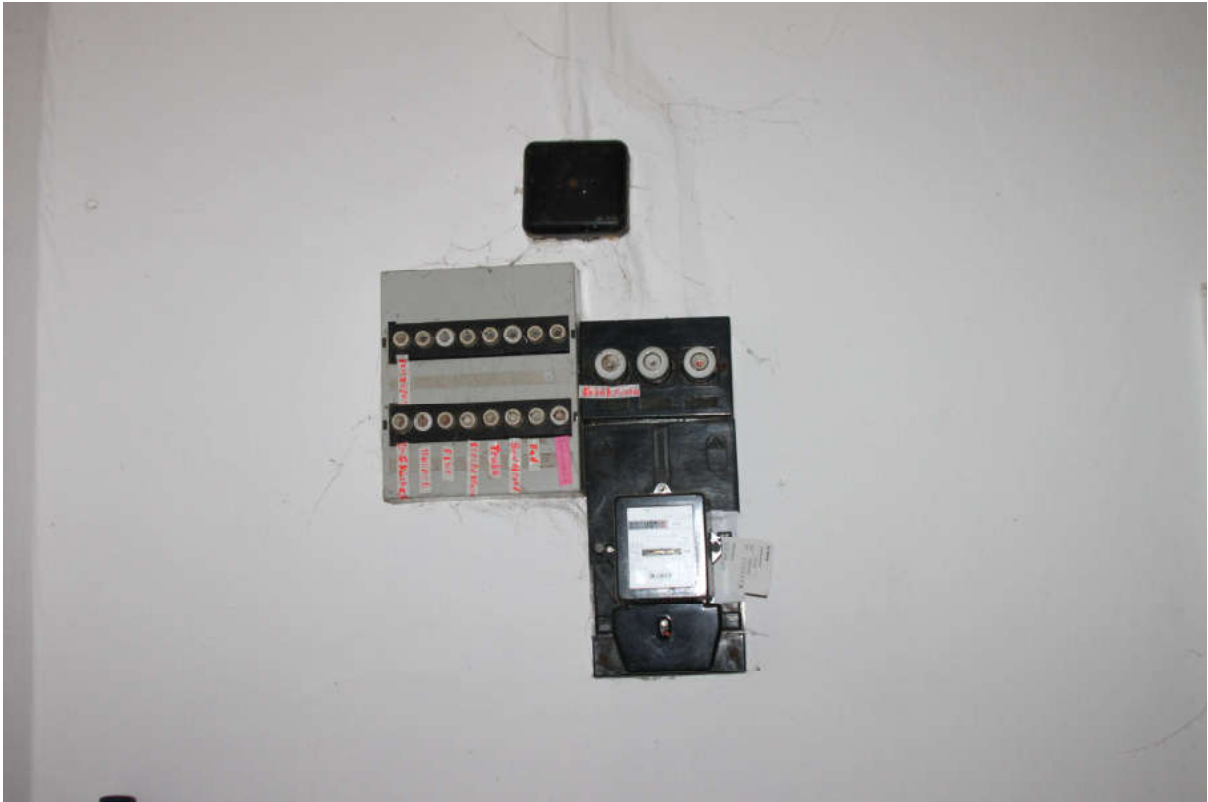
Bild 19: Sicht auf die Elektroanlage im Flur
