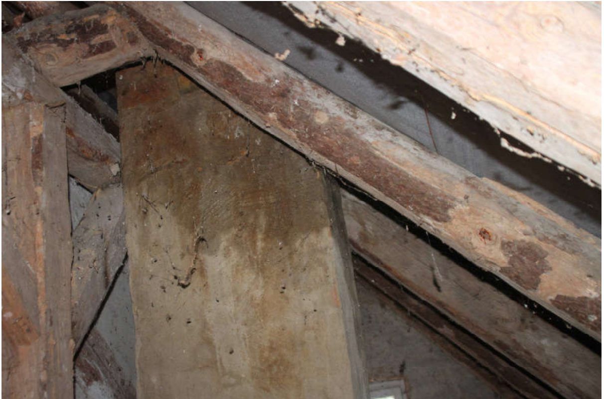
Bild 45: Sicht in die Abseite, Schornsteine durchfeuchtet
