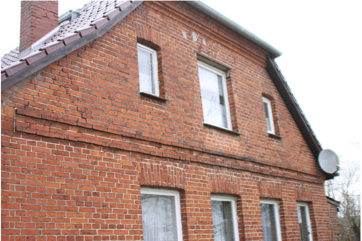
Bild 15: Detail der Giebelfassade (Südostansicht) teilweise offene Mauerwerksfugen und Setzungsrisse
