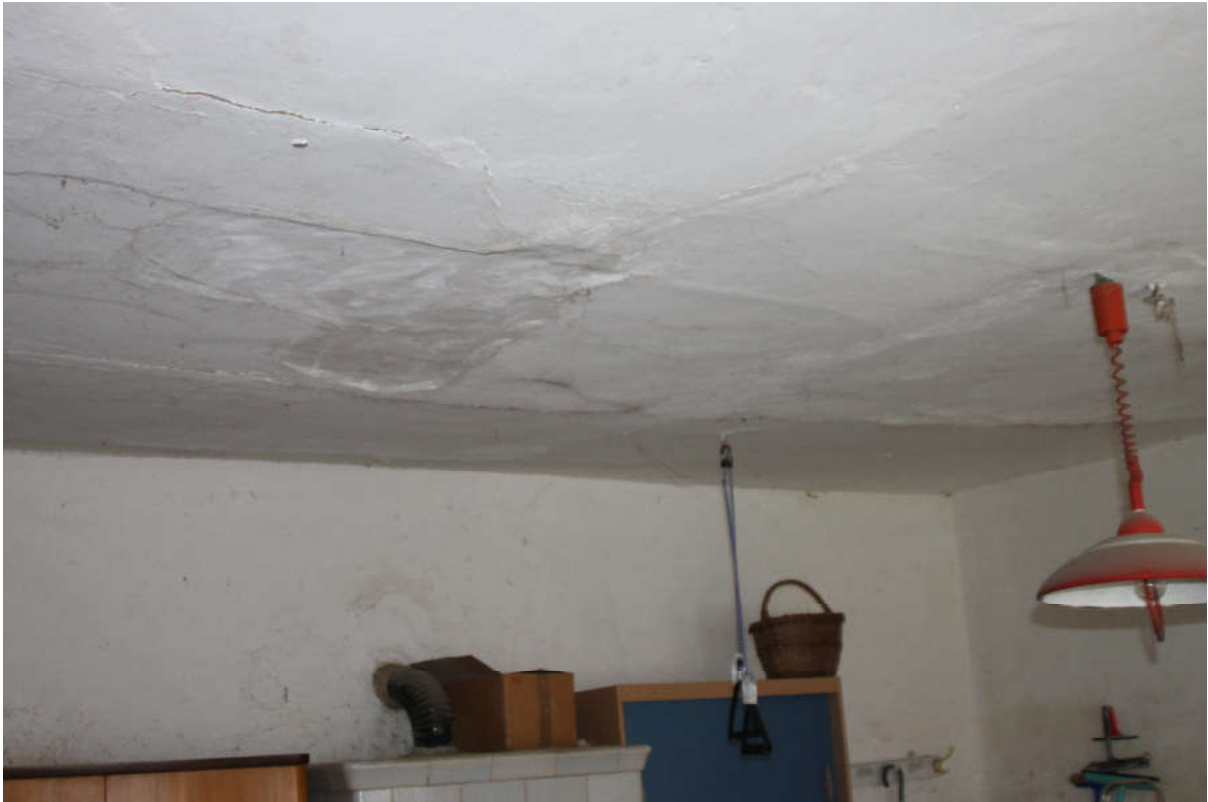
Bild 33 und Bild 34: Zustand der Holzbalkendecke, ehemaliger Klassenraum
