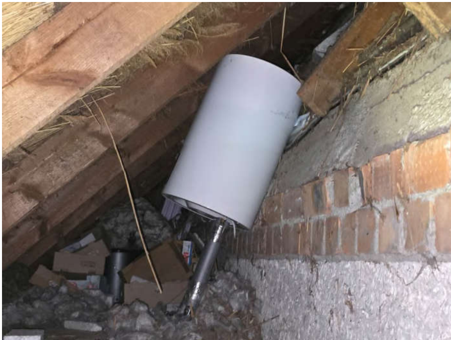
↑ Bild 23: Elektroboiler in der Abseite
