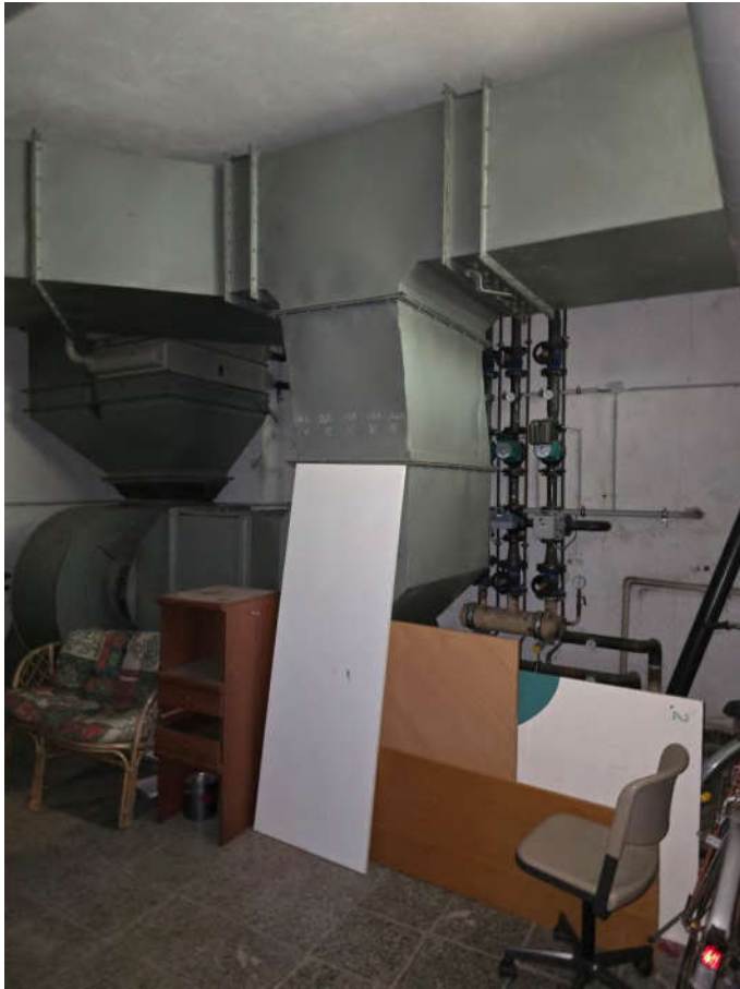
← Bild 33: Lüftungsanlage im Saalgebäude
