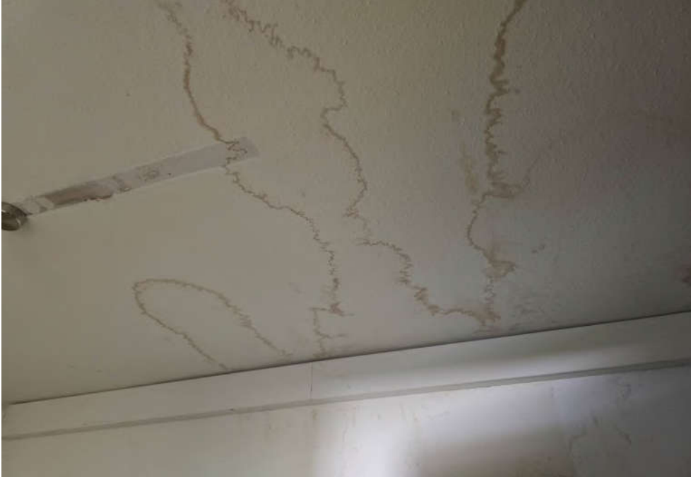
↑ Bild 15: Feuchteschaden im Deckenbereich
