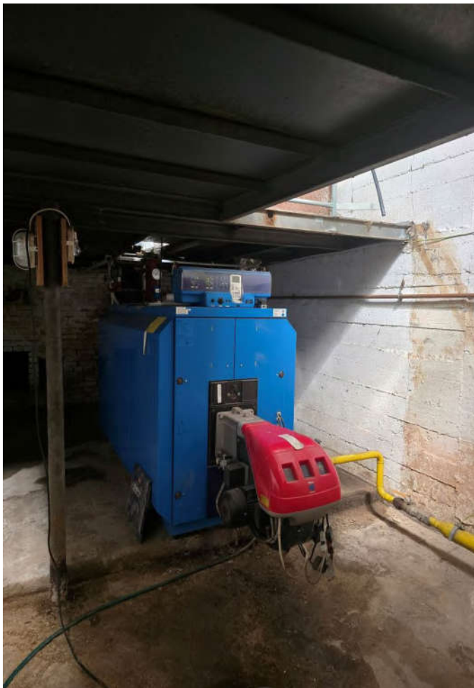
↑ Bild 10: Heizung in der Teilunterkellerung
