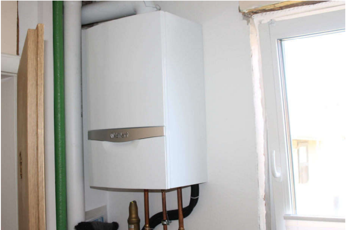
Bild 17 und Bild 18: Sicht auf die Brennwerttherme im Bad im Erdgeschoss
