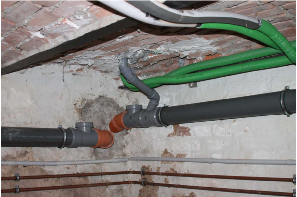
Bild 25 und Bild 26: Keller unter dem Bad
