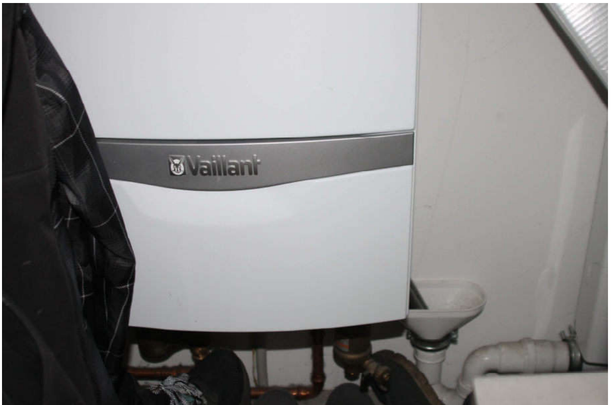
Bild 34: Brennwerttherme und Durchlauferhitzer in der Abseite im Dachgeschoss
