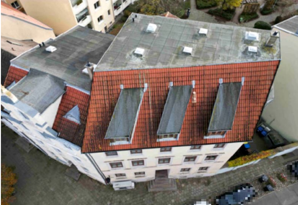
↑ Bild 5: Blick auf den Dachbereich mit Unebenheiten (Drohnenaufnahme)
