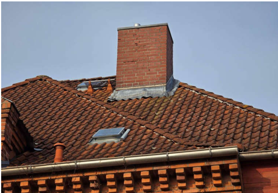
↑ Bild 34: schadhafte Abdeckung der Schornsteindurchführung
