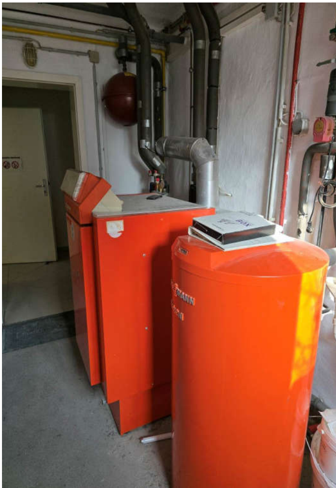
↑ Bild 8: Heizung im Keller des Wohnhauses
