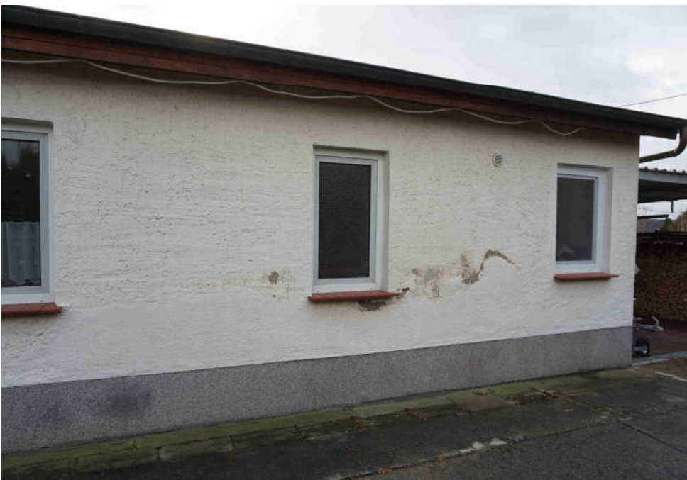
↑ Bild 4: massive Putzschäden an der nördlichen Außenwand
