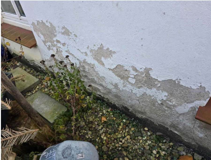
↑ Bild 7: Feuchteschäden im Sockelbereich des Kellergeschosses
