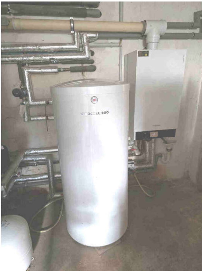
↑ Bild 4: Heizungsanlage im Kellergeschoss
