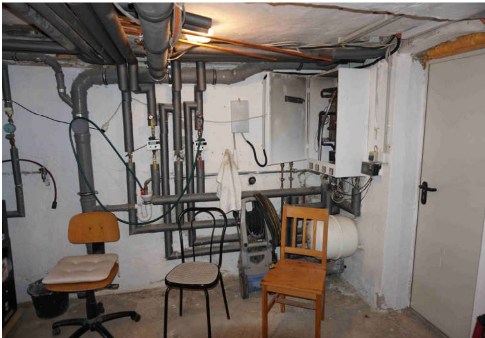
↑ Bild 8: Teilunterkellerung mit Übergabestation der Fernwärme
