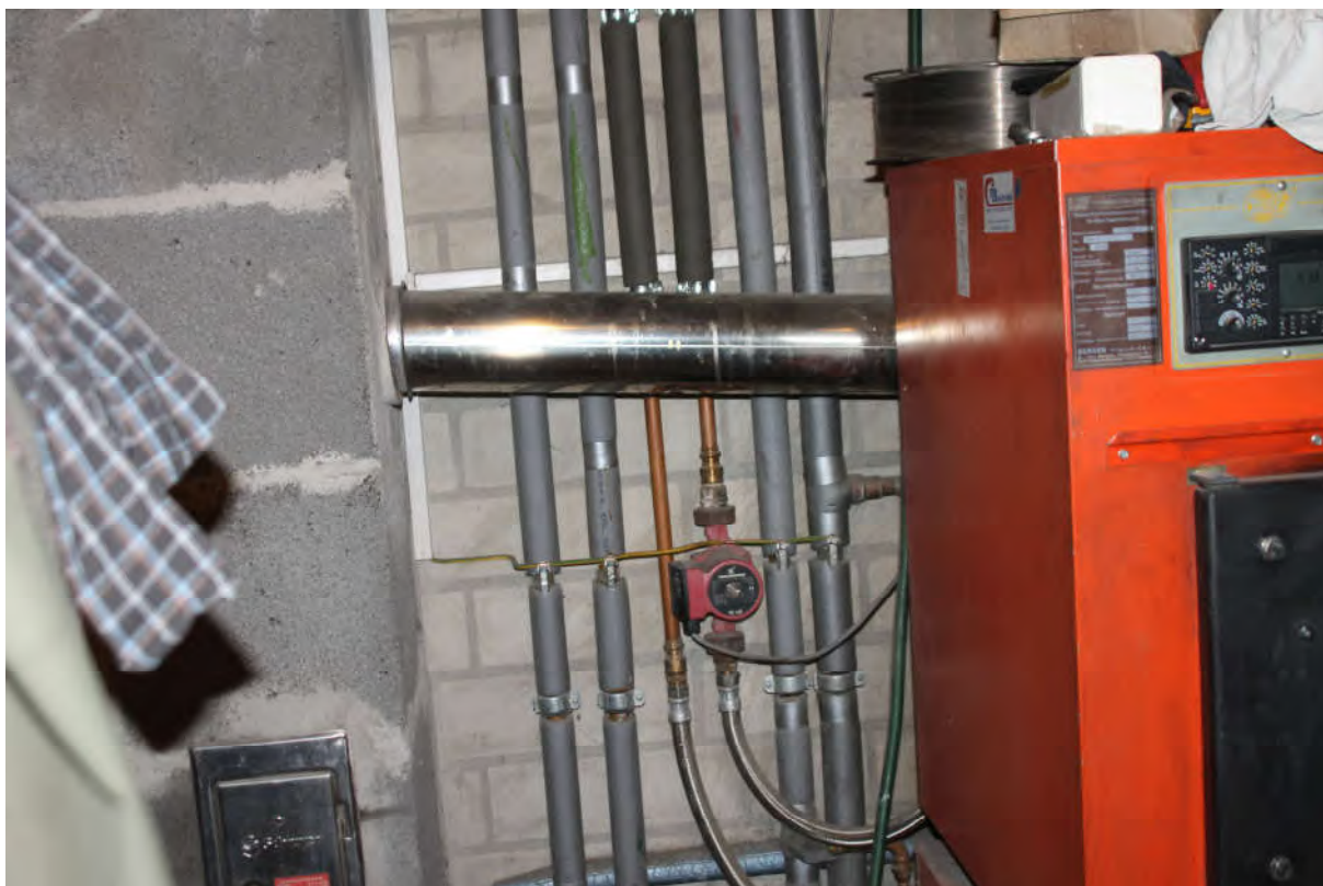
Bild 21 und Bild 22: Blick auf die Ölheizung mit Warmwasseraufbereiter in der Unterstellhalle
