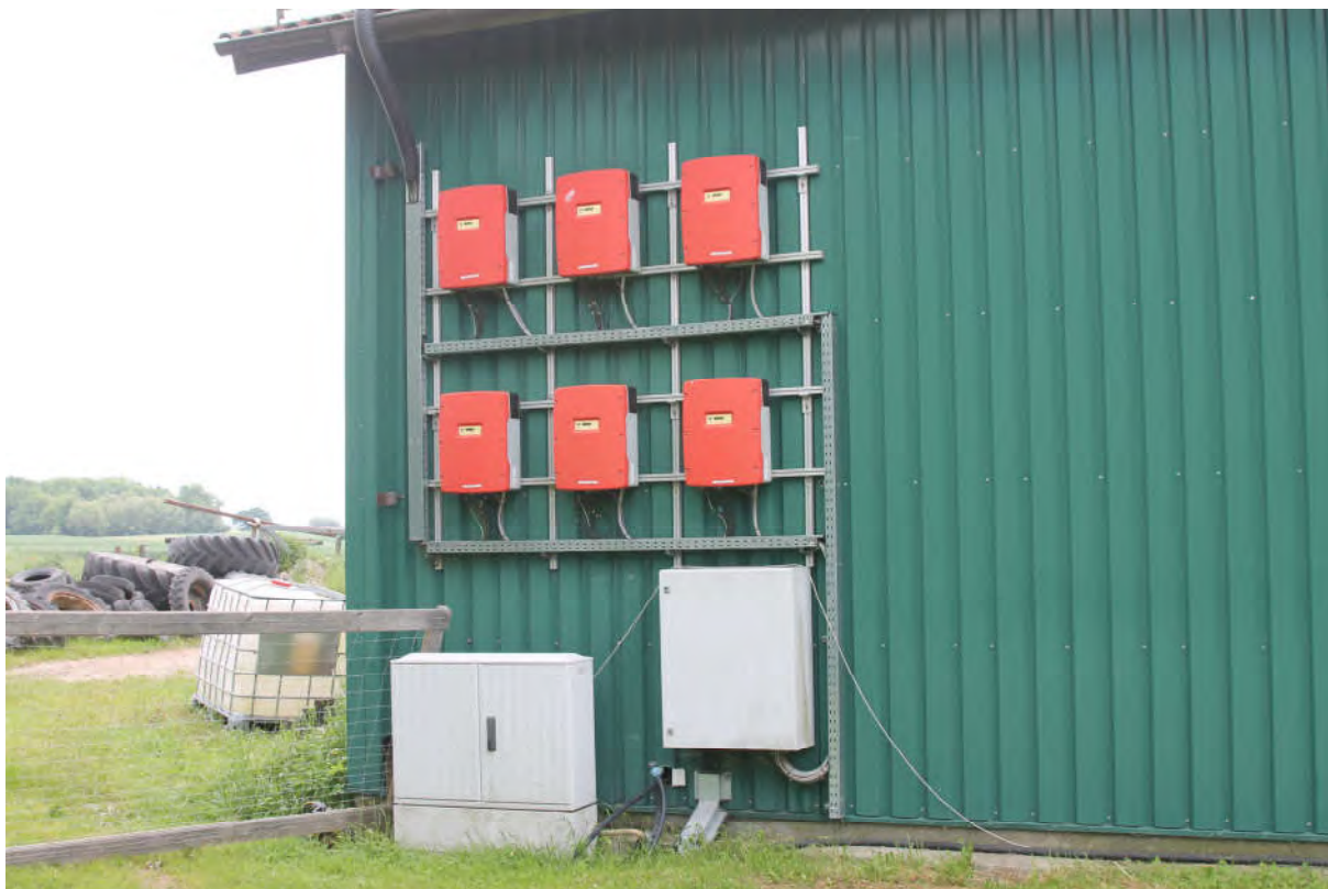
Bild 8: Sicht auf die Wechselrichter der PV-Anlage
