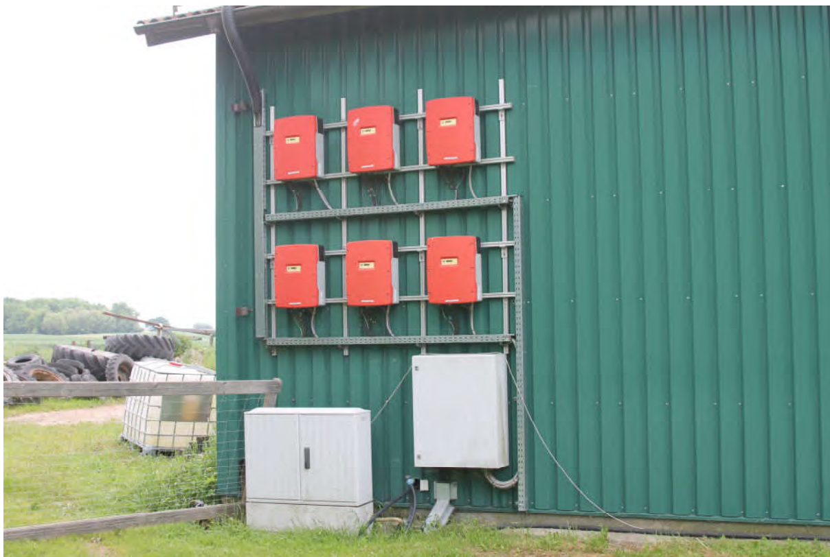
Bild 8: Sicht auf die Wechselrichter der PV-Anlage
