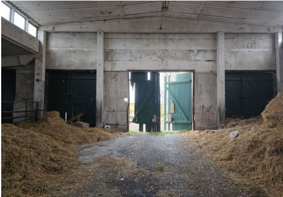
↑ Bild 5: Innenansicht mit Blick auf die maroden Tore
