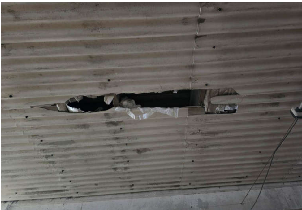
↑ Bild 8: Schadensbild an der Dachverkleidung
