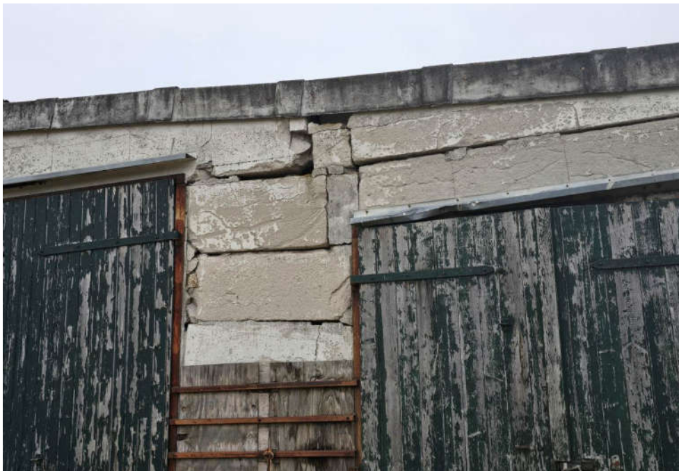
↑ Bild 2: Schadensbild an der Betonwand
