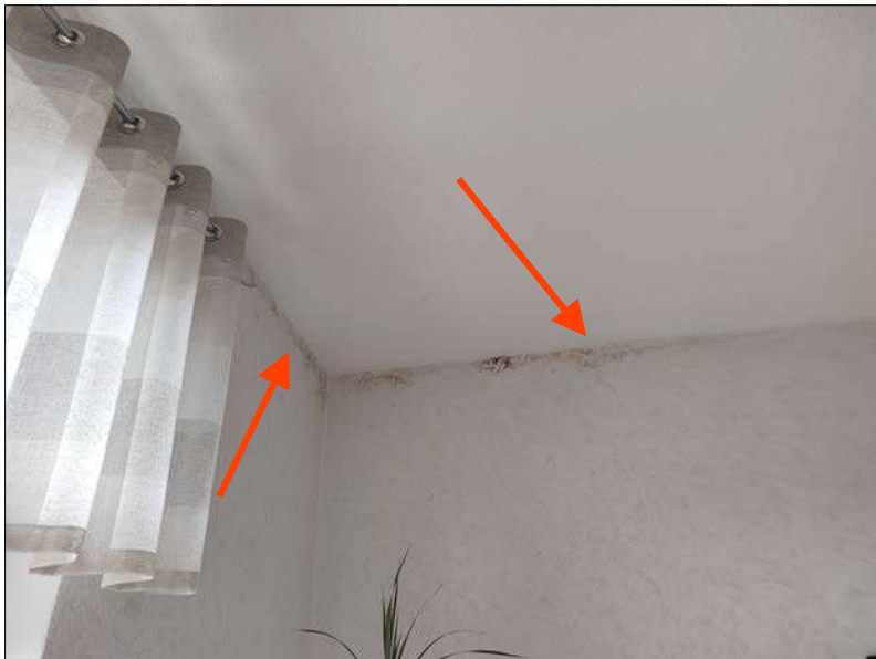
Schimmelbildung innerhalb der Whg. im OG
