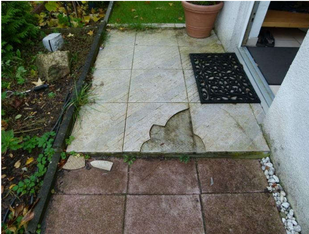
Bild 25 - Bodenbelag Podest beschädigt
