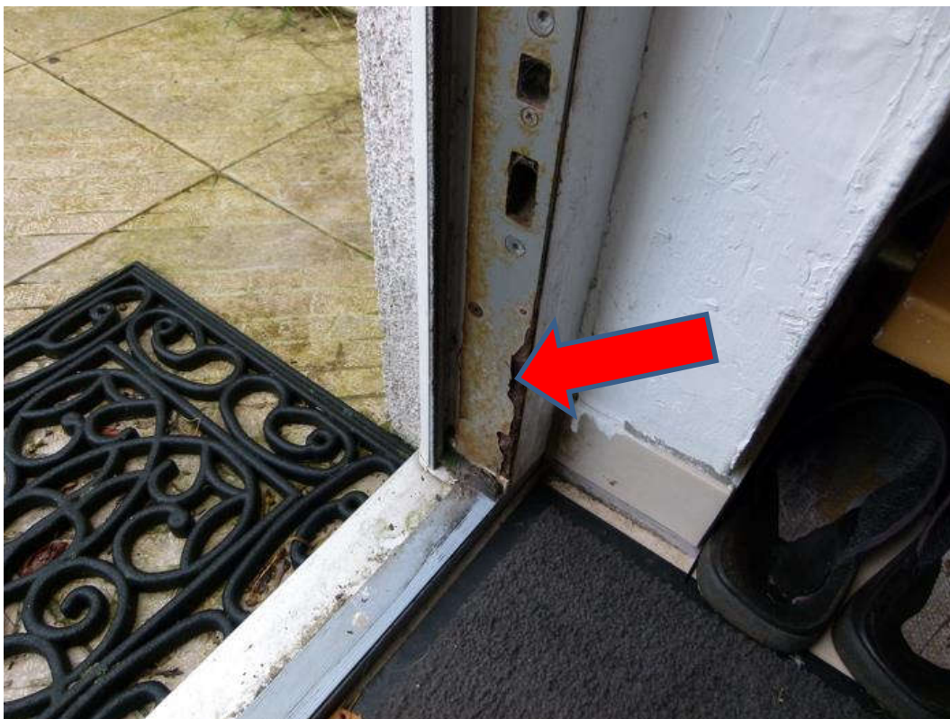
Bild 2 - Rost am Schließblech der Haustür
