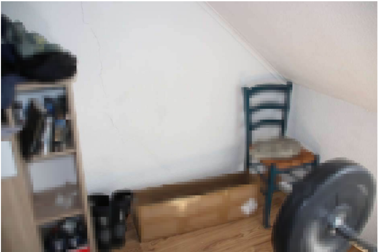
Bild 23: Mauerwerksriss im Bereich des Giebels
