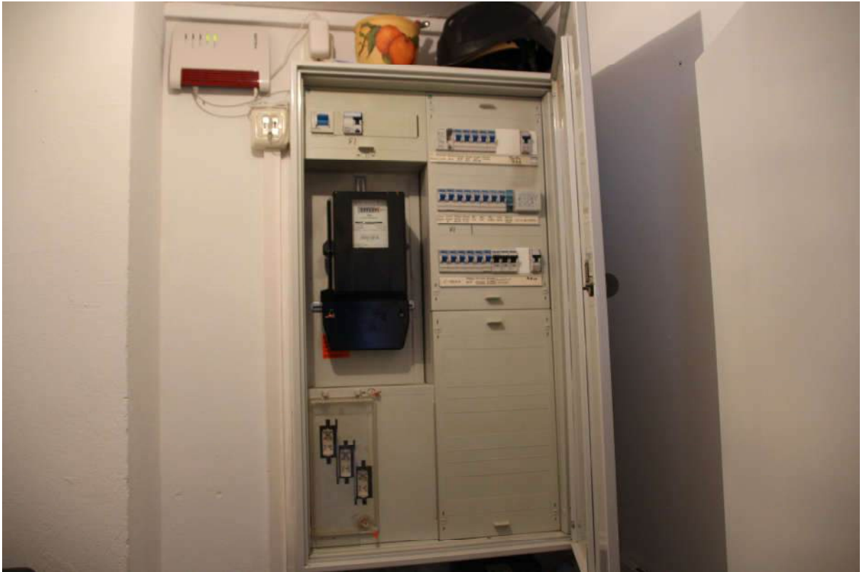
Bild 19: Zählerschrank im Abstellraum
