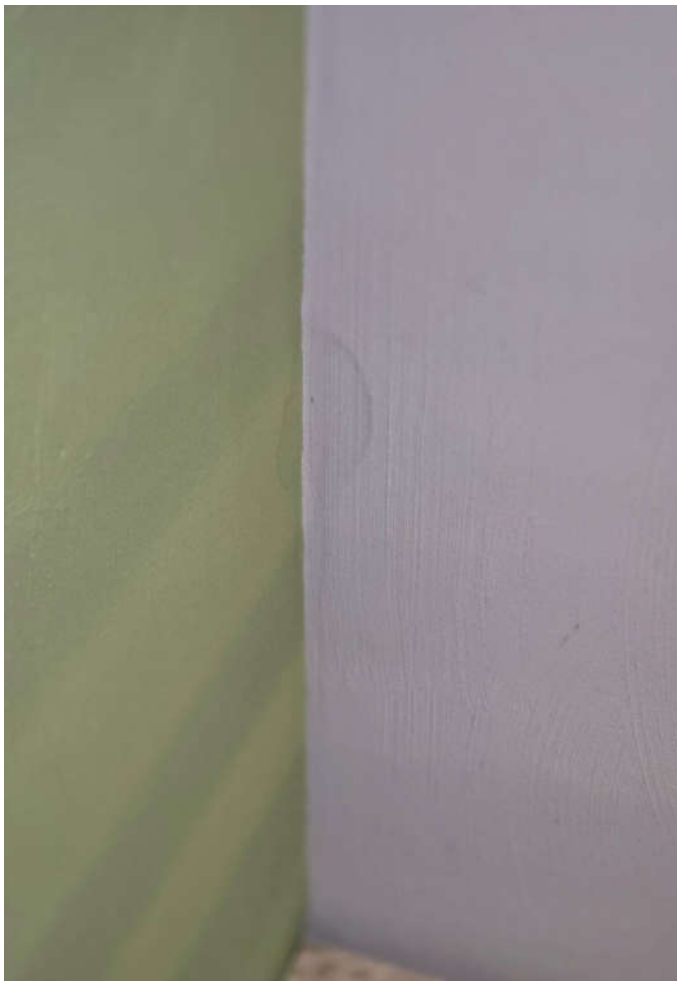
↑ Bild 18: Feuchteschaden im Treppenhaus
