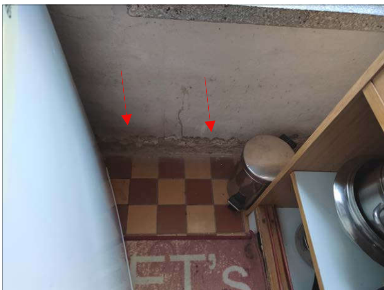
Salzausblühungen mit Putzfehlstellen
