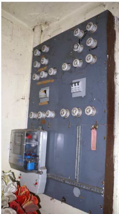
Bild 11 E-Verteileranlage mit Schraubversicherungen
