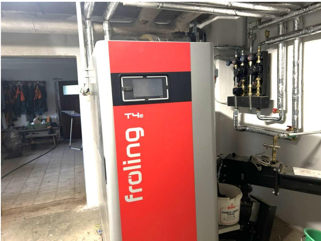
Bild 8: Heizraum mit Heizanlage im Zubau
