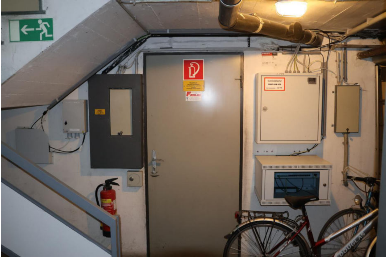
Bild 37 KG Stiegenhaus allgemein mit Technik-Installationen
