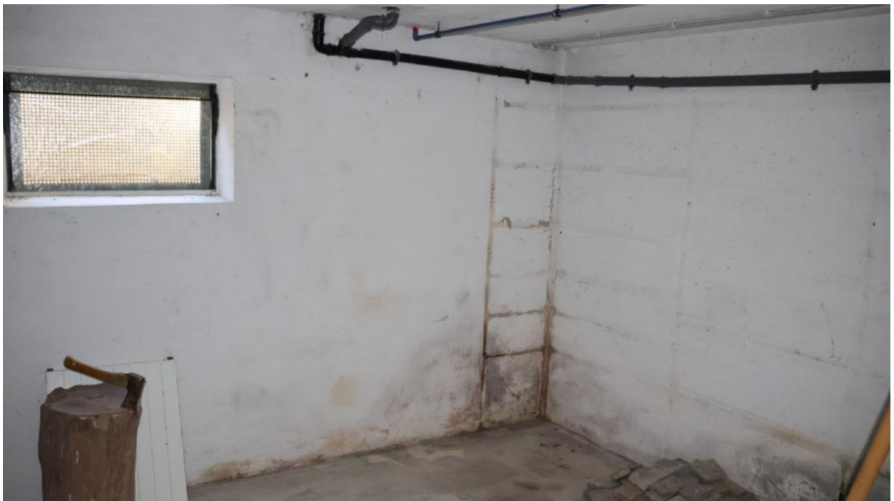
Bild 46 Keller mit starken Feuchtflecken an der Außenwand
