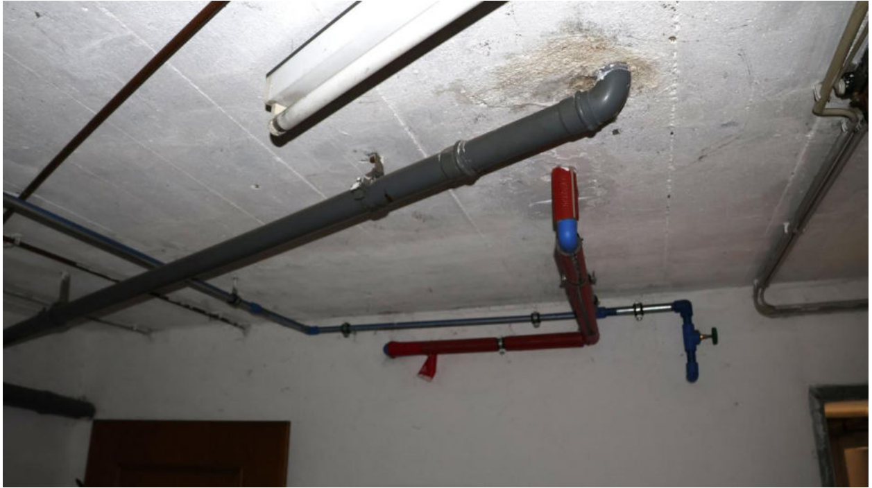
Bild 49 Installationen an der KG-Decke
