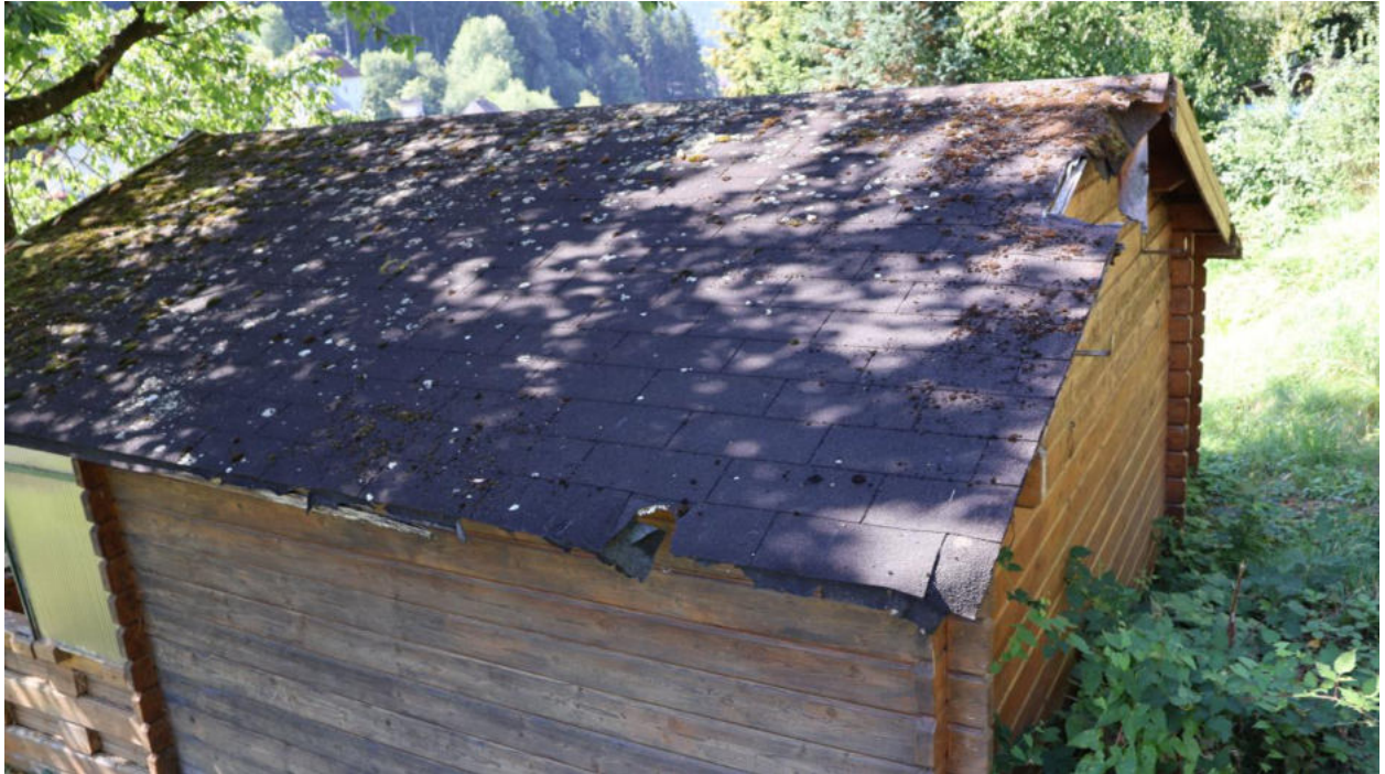
Bild 57 Beschädigte Dacheindeckung Gartenhütte Ostseite
