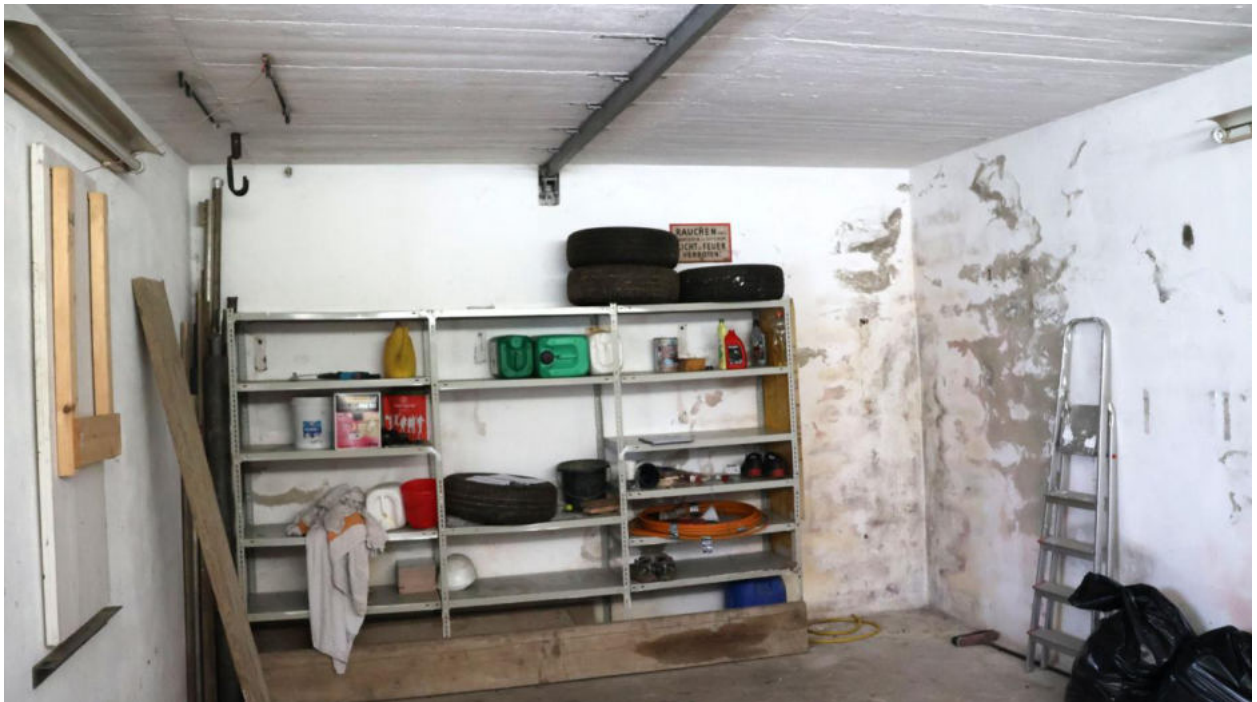
Bild 44 KG Garage mit starken Feuchtflecken an der Nordwestseite
