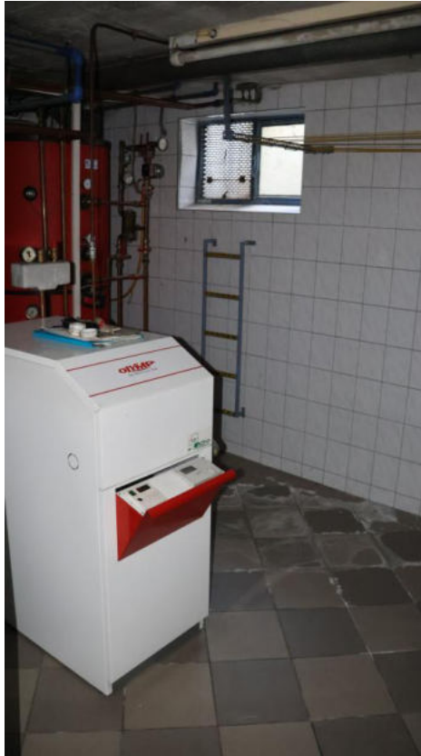
Bild 51 KG Heizraum mit Ölkessel und Warmwasserboiler
