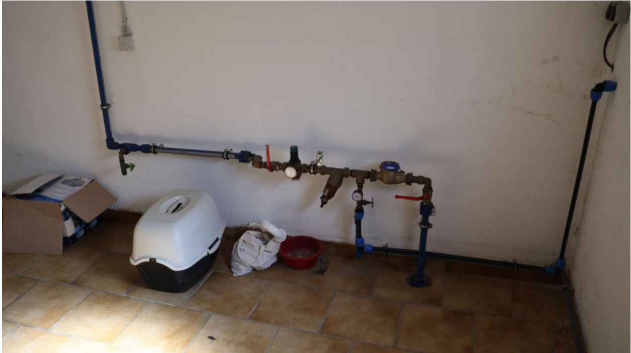
Bild 41 Wasseranschluss mit Wasseruhr und Gartenleitung
