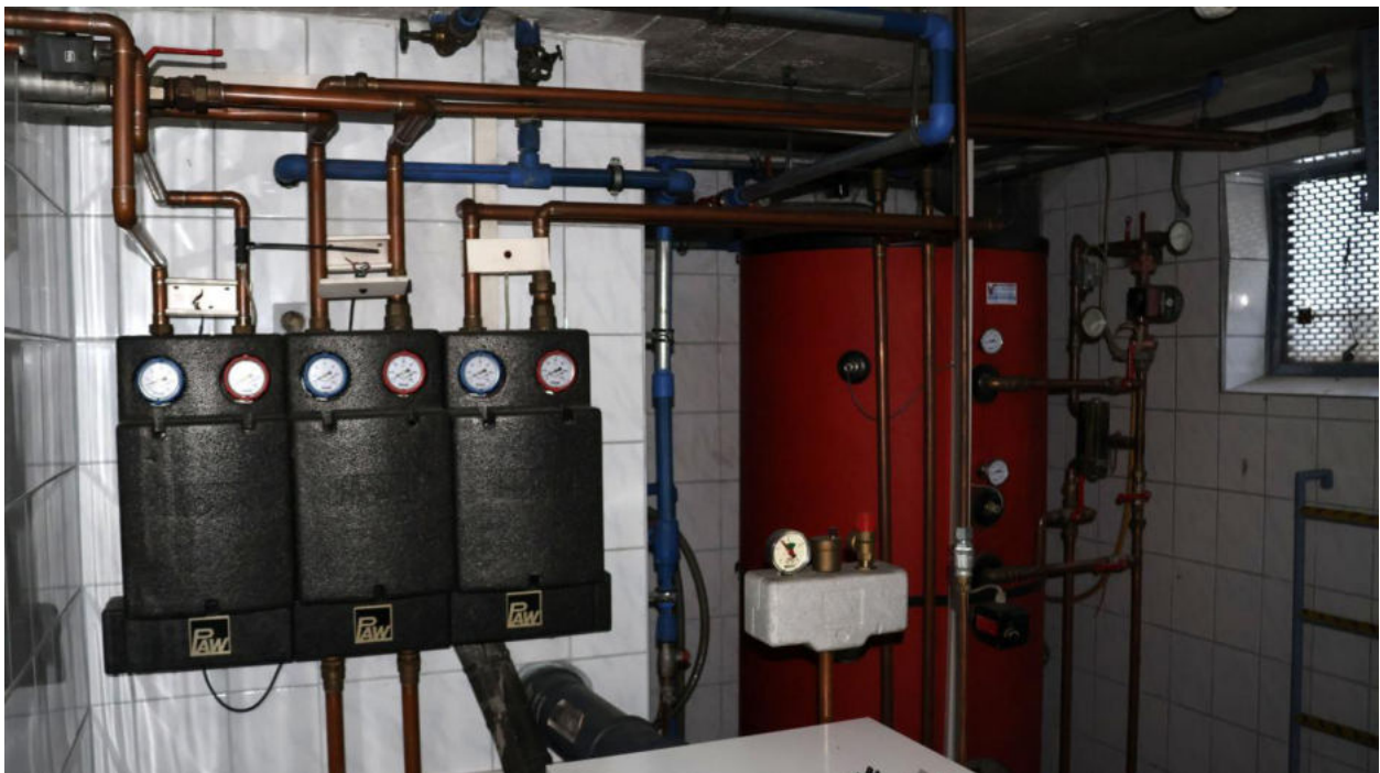
Bild 52 KG Heizraum mit Heizungsverteilung und Warmwasser-Pufferspeicher
