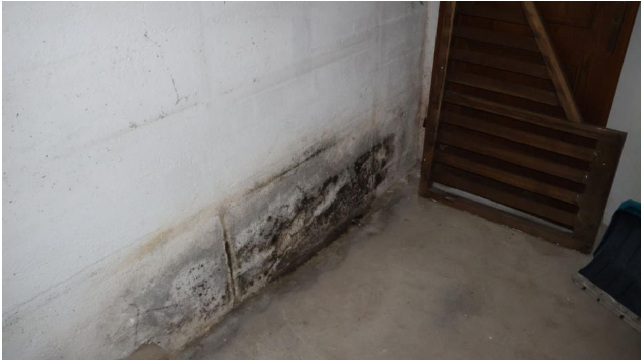
Bild 47 Feuchte- und Schimmelbildungen KG-Außenwand
