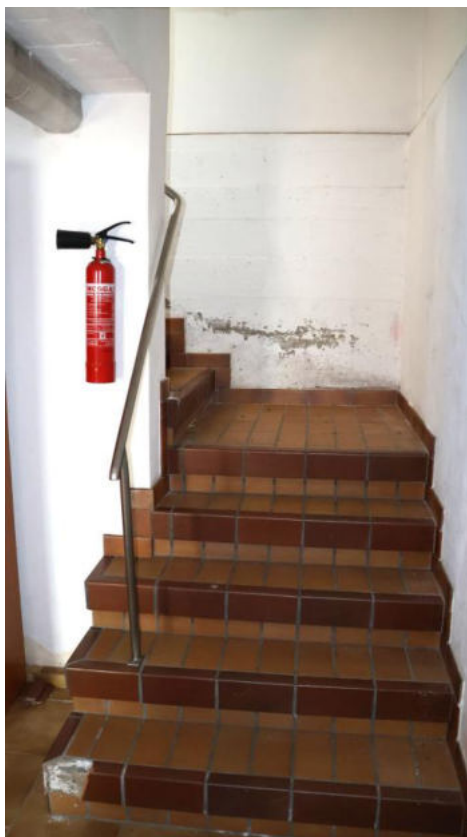
Bild 54 Stiegenabgang in den KG Vorraum mit Feuchteschäden an der nördlichen Außenwand
