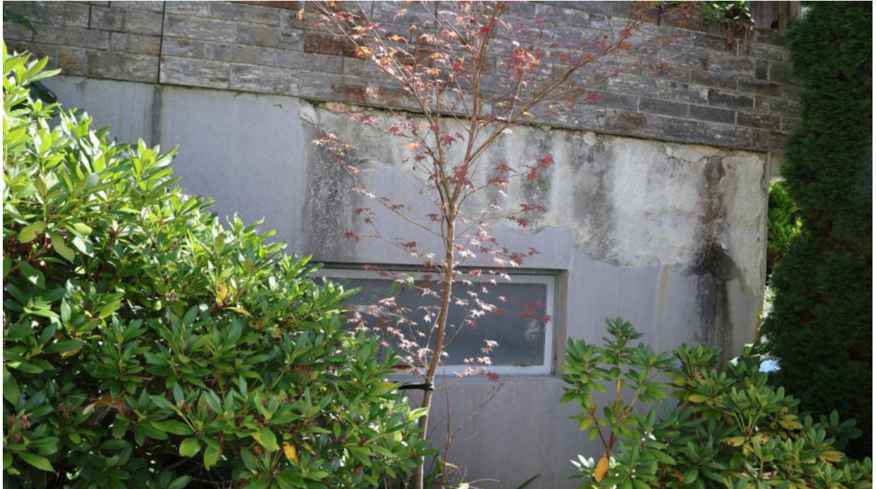
Bild 69 Westliche Garagenaußenwand mit beschädigter Außenwandfassade vom begrünten Flachdach
