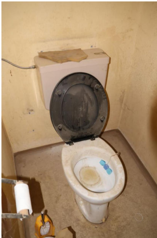
Bild 38 WC im Maschinenraum 2
