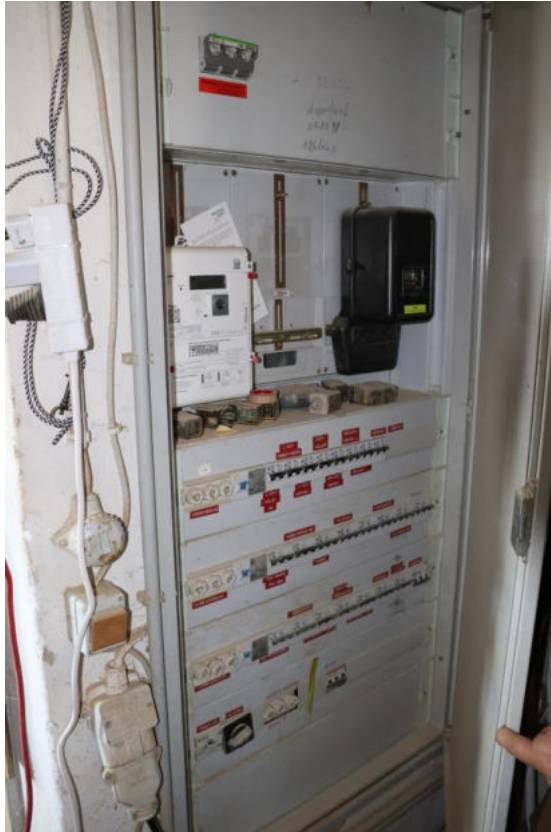
Bild 25 E-Verteiler im Maschinenraum
