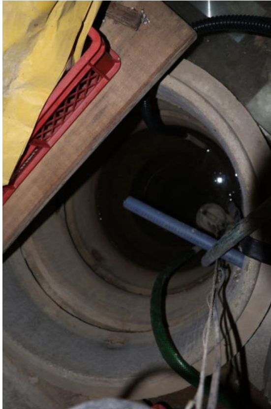
Bild 31 Grundwasserschacht mit Tauchpumpe
