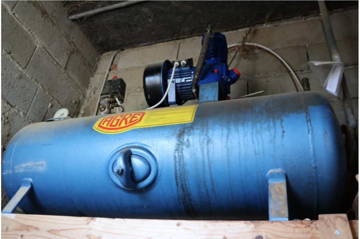
Bild 27 Kompressor im Stiegenhausbereich
