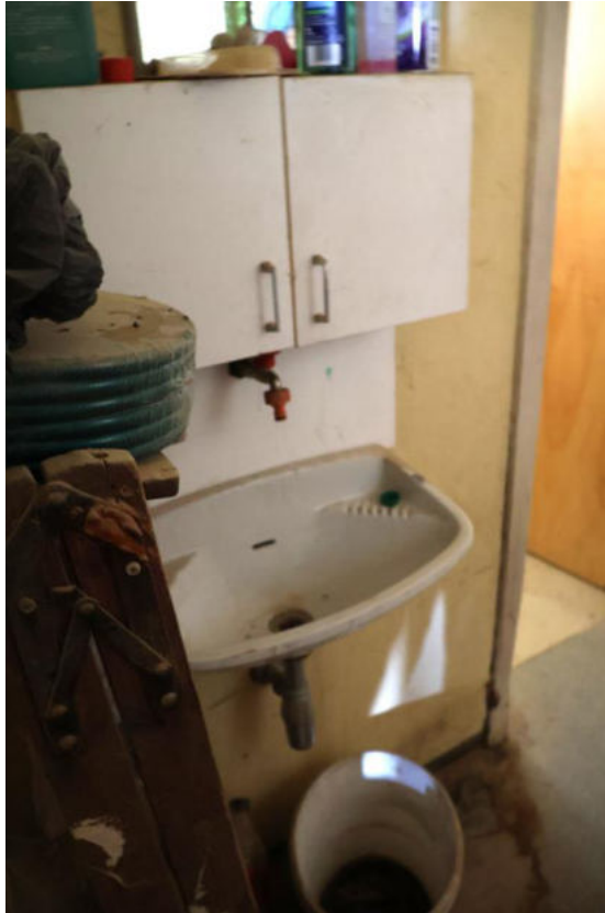
Bild 37 Handwaschbecken im Maschinenraum 2
