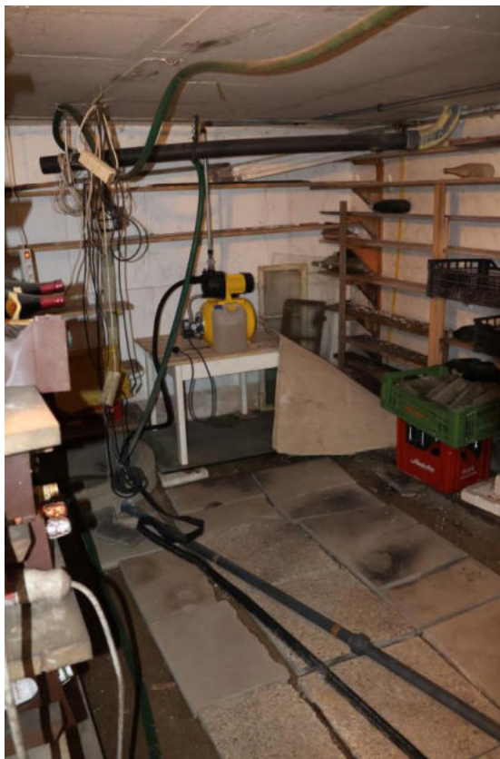
Tiefbrunnen mit Wasserpumpe als Nutzwasserversorgungsanlage
