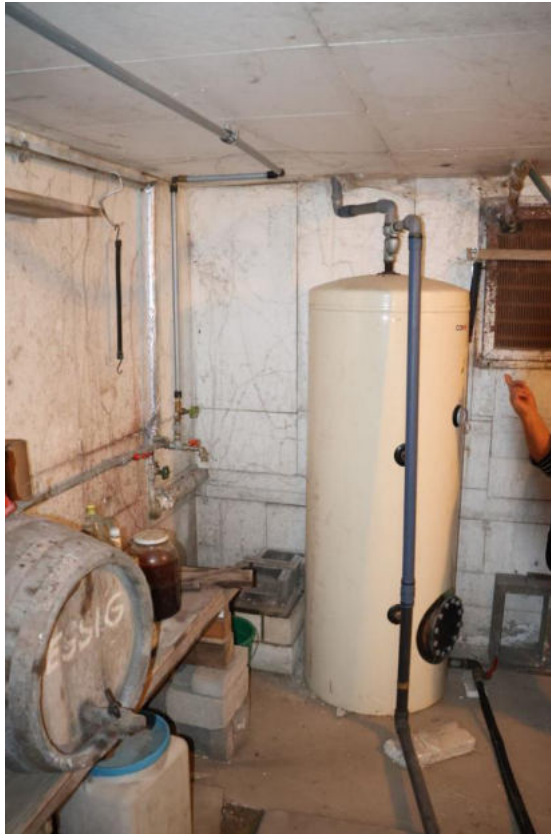
KG Mostkeller mit Wasserinstallation und Wasserboiler
