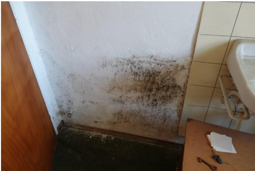
Abbildung 30 Wasserschaden Zimmer EG
