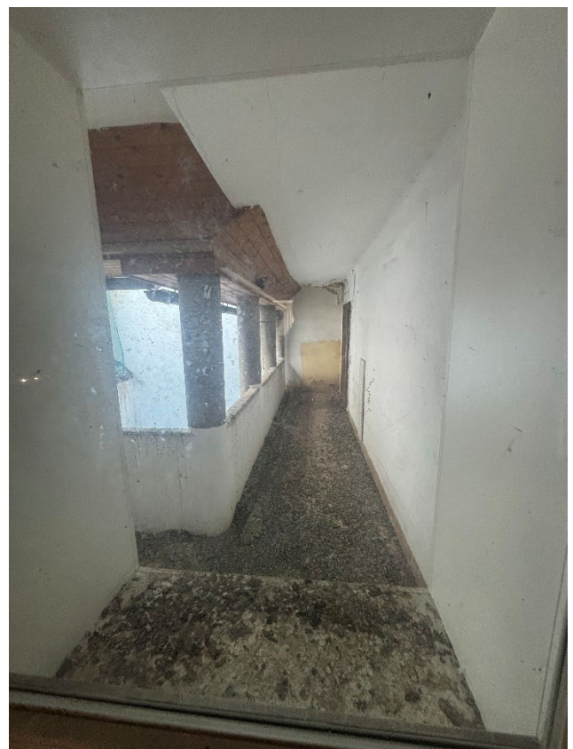
Gang im Obergeschoß (Taubenkot)
