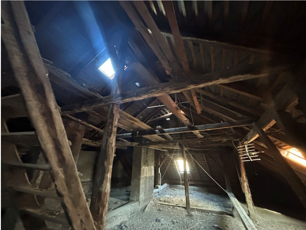
Dachboden (stark verkotet, viele tote Tauben)
