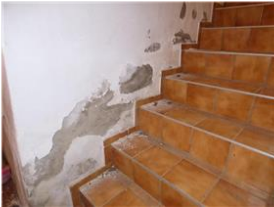
Feuchteschäden bei Stiegenaufgang
