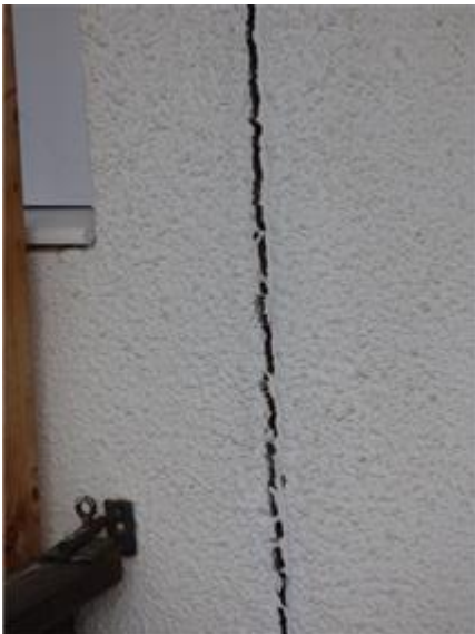
Mauerriss zwischen Altbau Top 4 und Zubau Top 3
