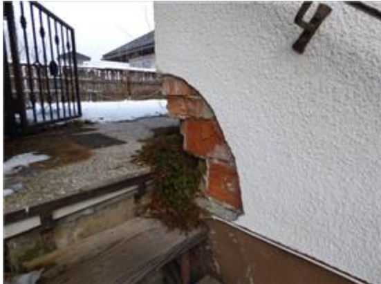
Zugang zur Terrasse mit schadhaftem Mauerwerk
