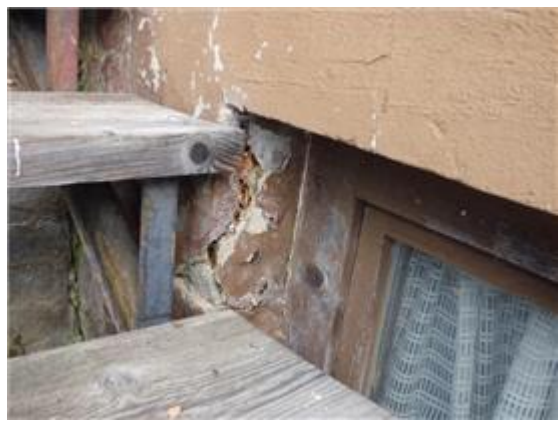
Kellergeschoß mit schadhaftem Mauerwerk
