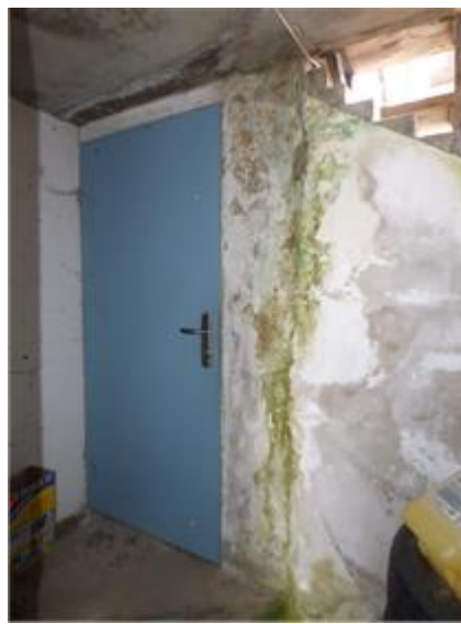
Kellerzugang mit Feuchteschäden
