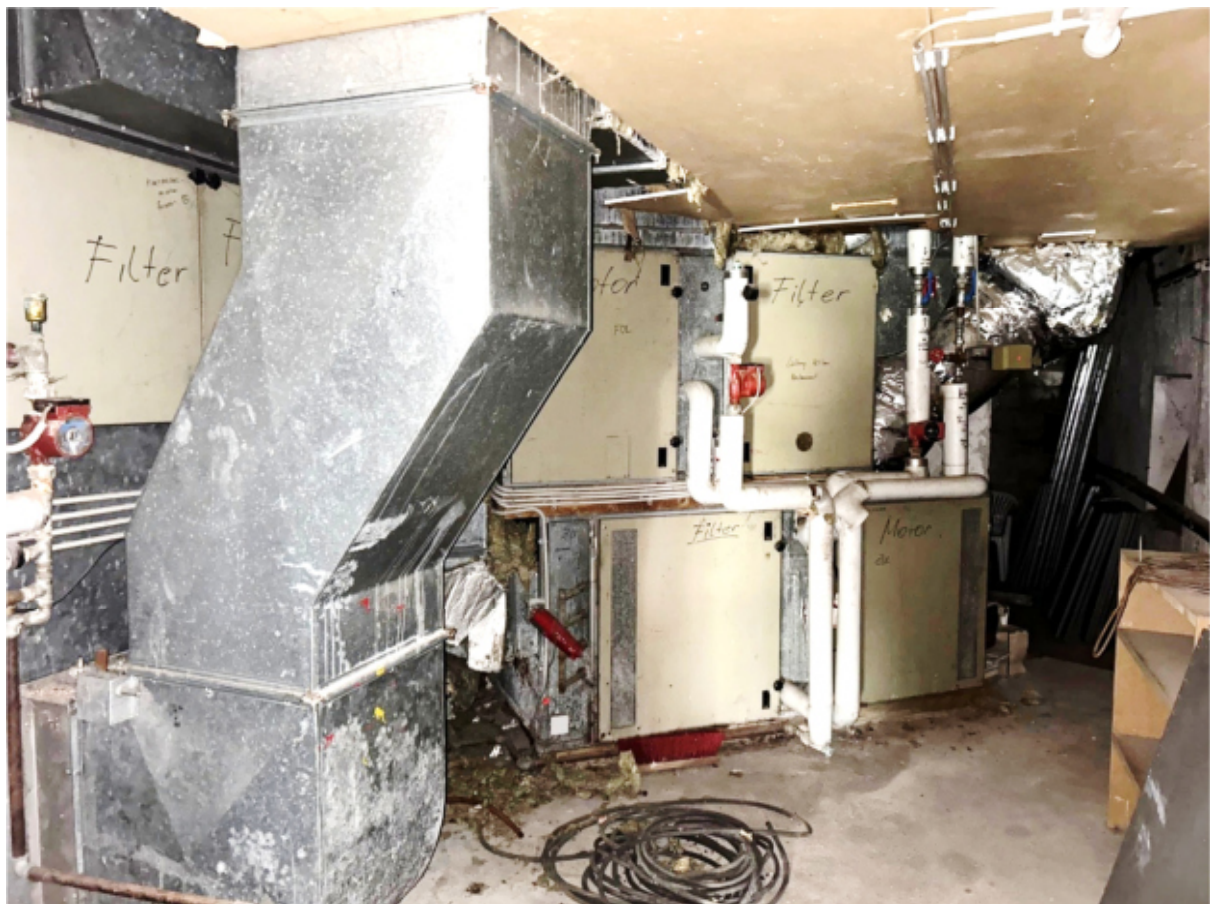
BE- UND ENTLÜFTUNGSANLAGE - FOTO 190
