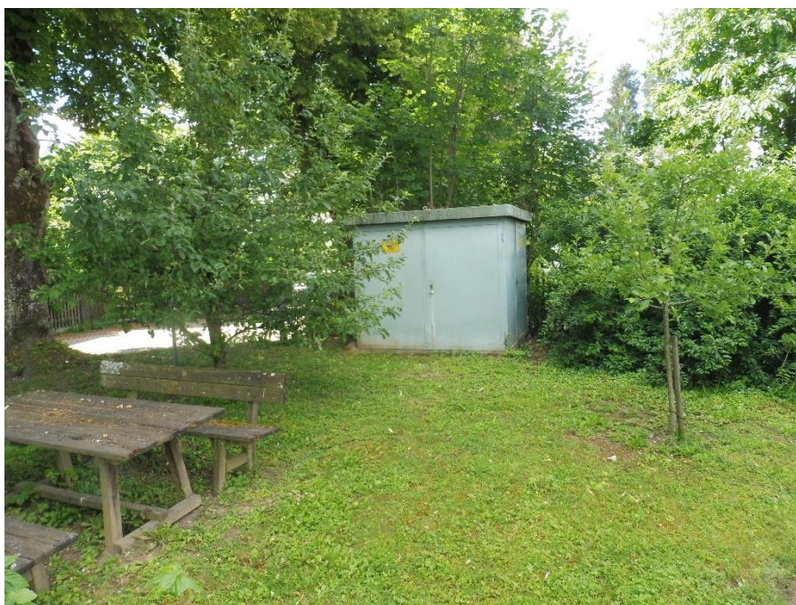
Kelag – Umspannstation (unten)
