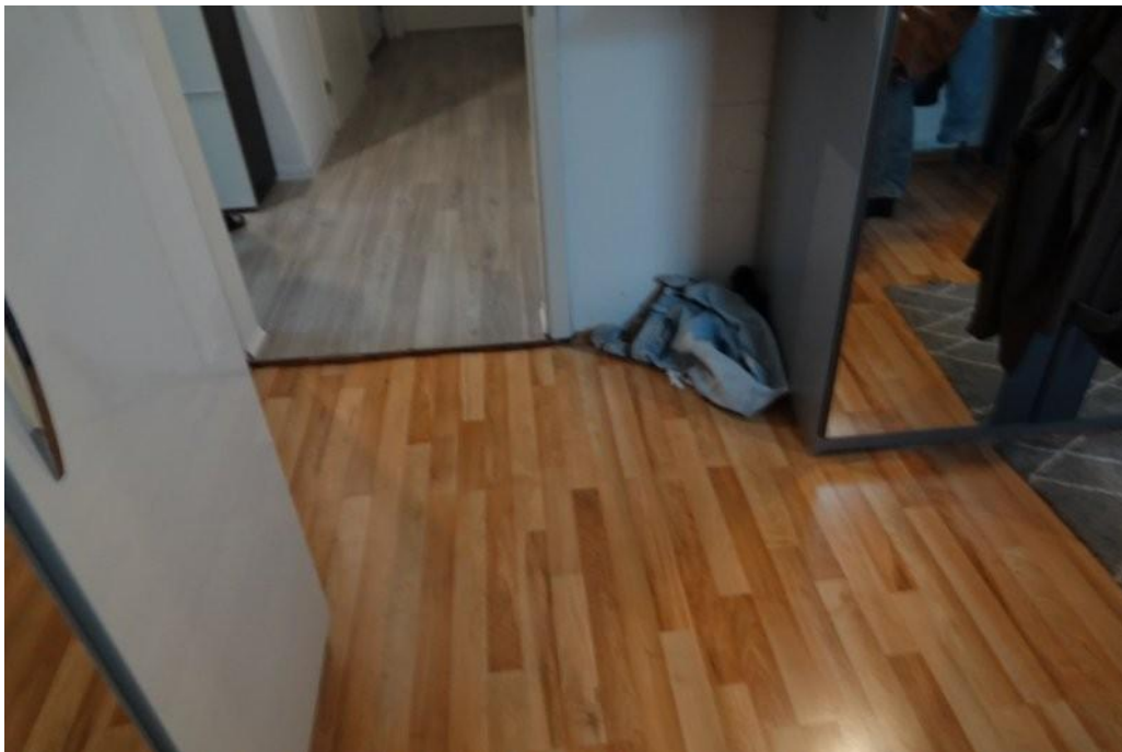
Abbildung 12 laienhaft verlegte Böden
