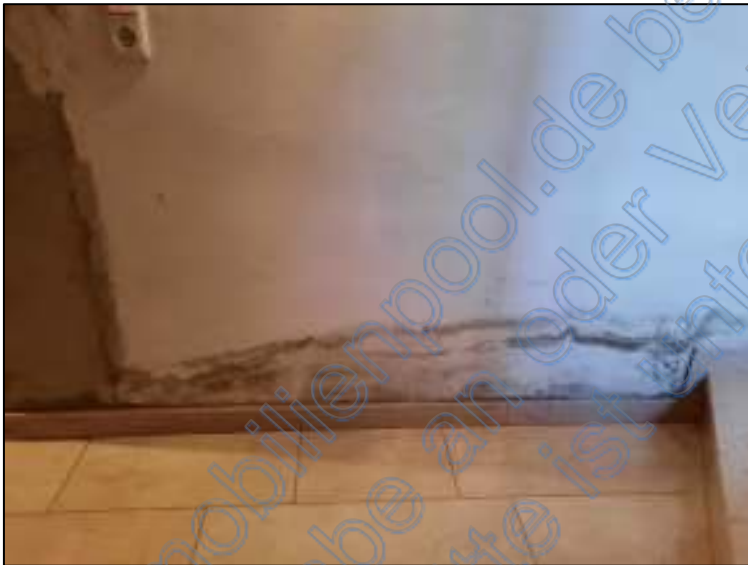
Abb. 11: Treppenhaus Kellergeschoß, Putzschaden
