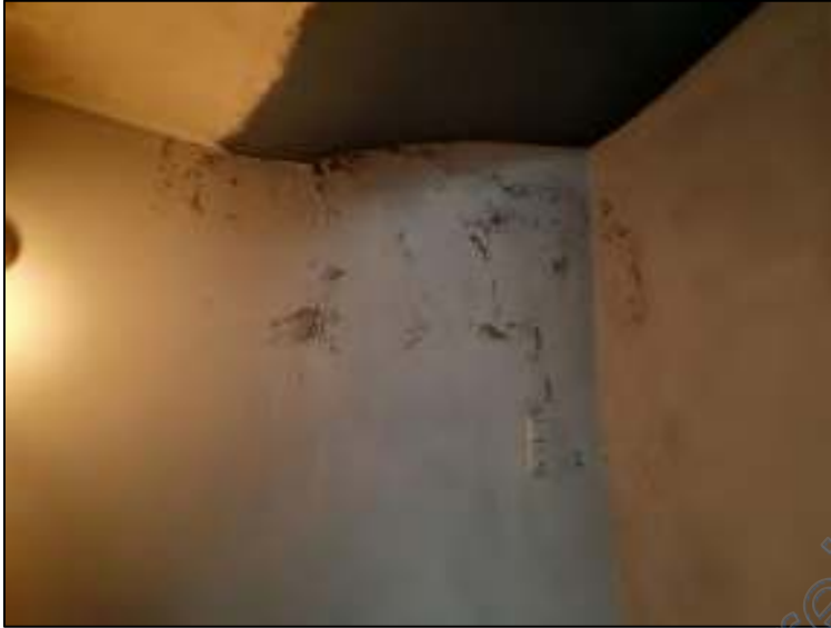
Abb. 10: Treppenhaus Kellergeschoß, Putzschaden
