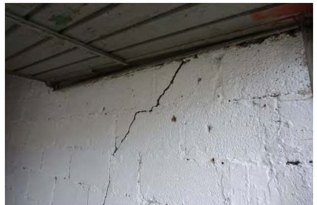
7.4.12 Bauschaden, Risse im Mauerwerk (exemplarisch)
