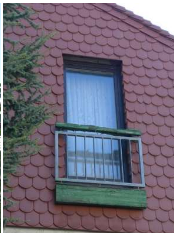
8 b Giebel, schadhafte Holzteile
