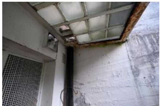
Schadhafte Glasbausteine zwischen Keller und Terrasse
