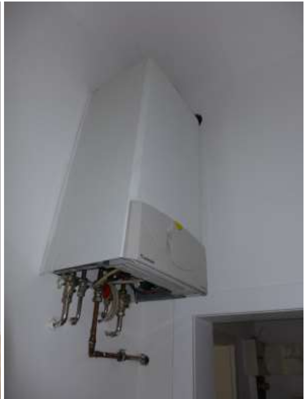
13 b Heizung Erdgeschoss links
