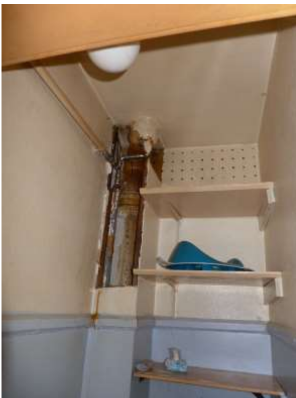
28 a Leitungsschaden Hinterhaus OG links
