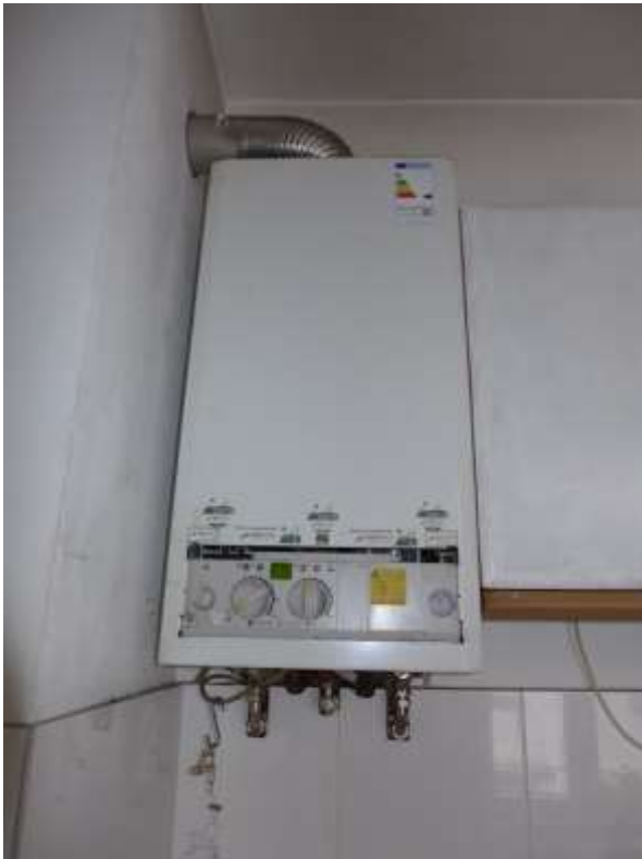
15 a Heizung Obergeschoss rechts
