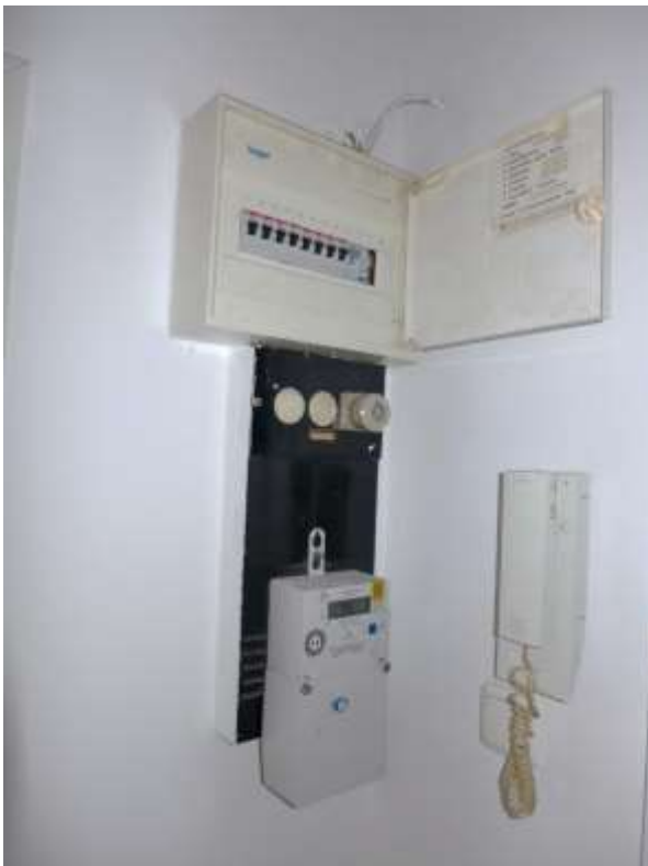
14 erneuerte Elektroverteilung Einzimmerwohnung Erdgeschoss links
