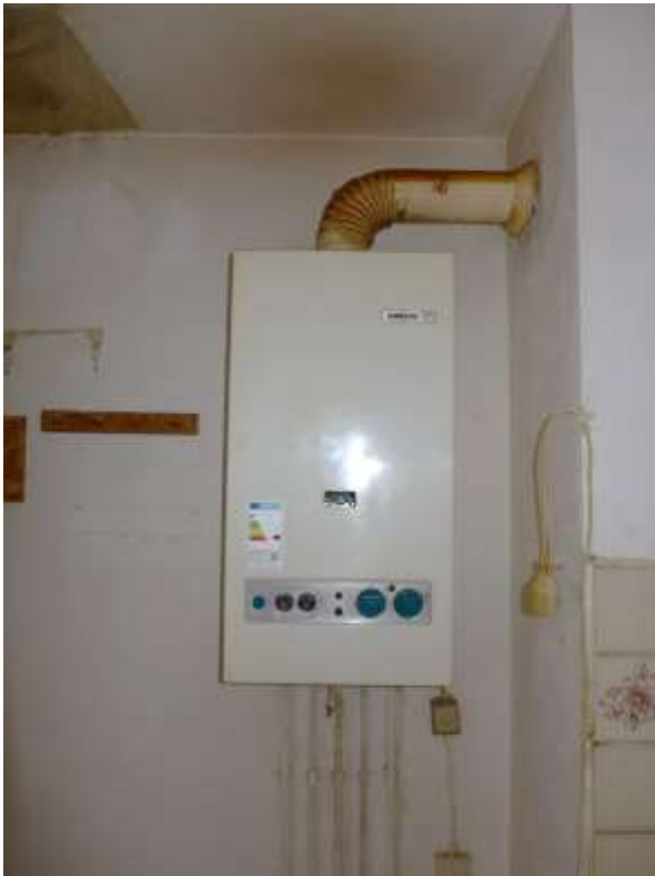
27 a Heizung Hinterhaus OG links
