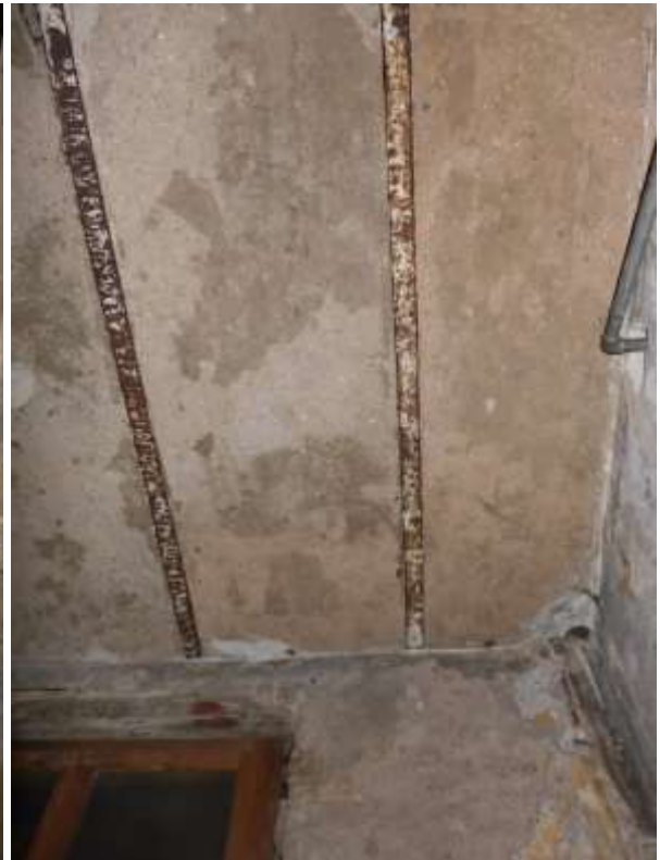
31 b korrodierte Eisenträger
