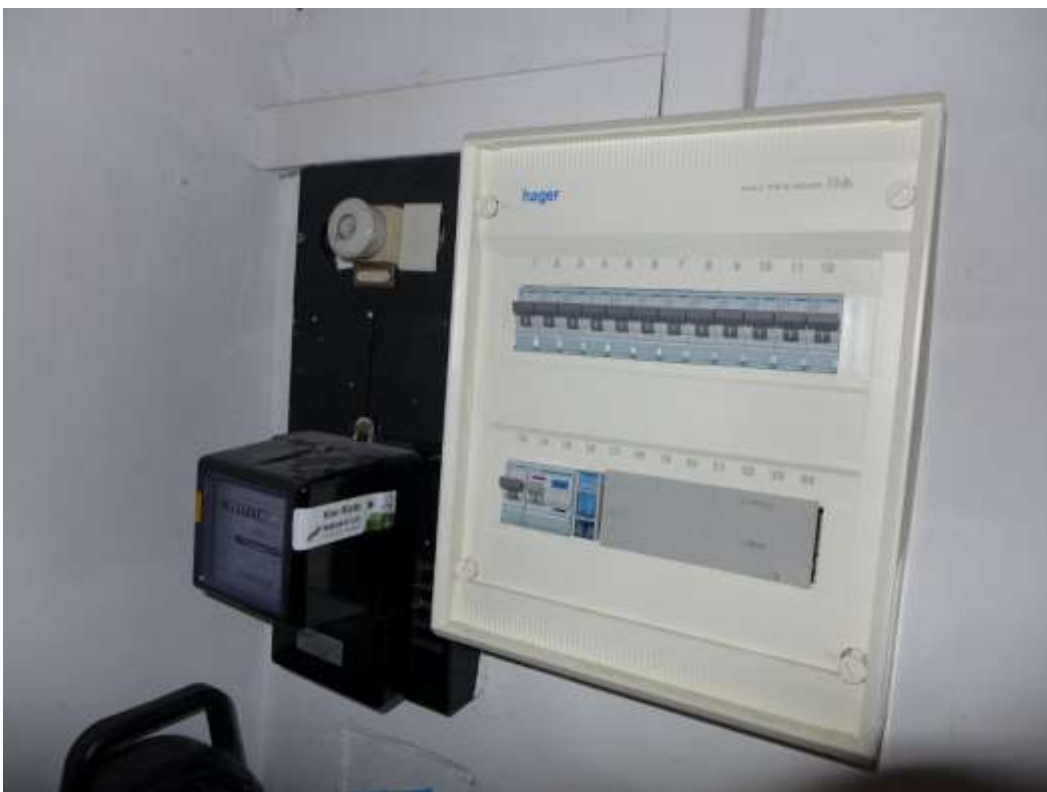
16 erneuerte Elektroverteilung Wohnung Obergeschoss rechts
