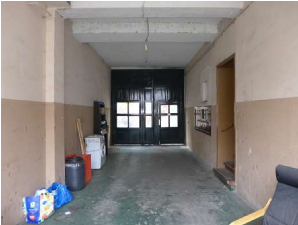
17 Zustand Durchfahrt Vorderhaus
