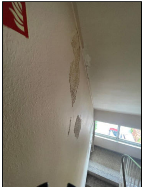
Ehem. Wasserschaden durch Kaminschacht
